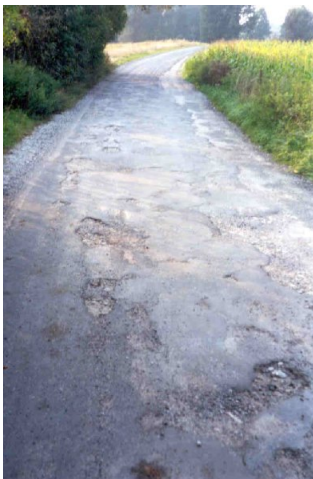
Przykład źle utrzymanej drogi
