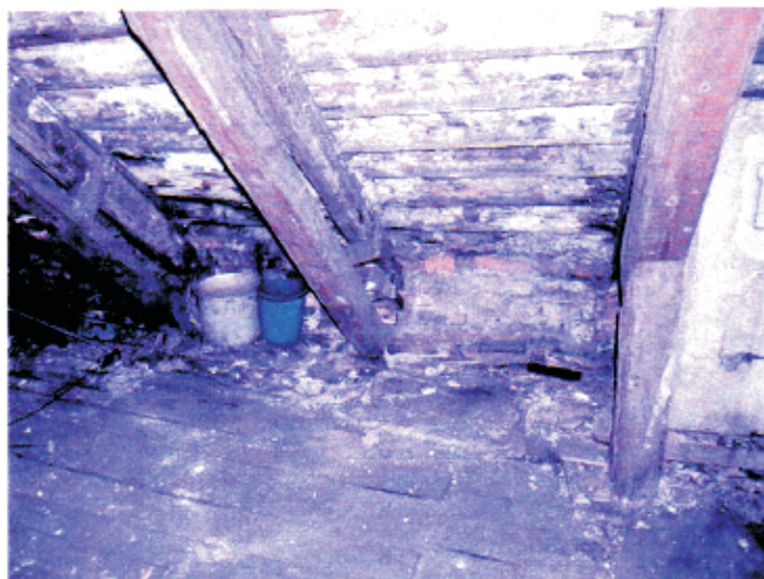
fot.6 Przeciekający dach (widoczna korozja dachówki laceria i krokwi)
