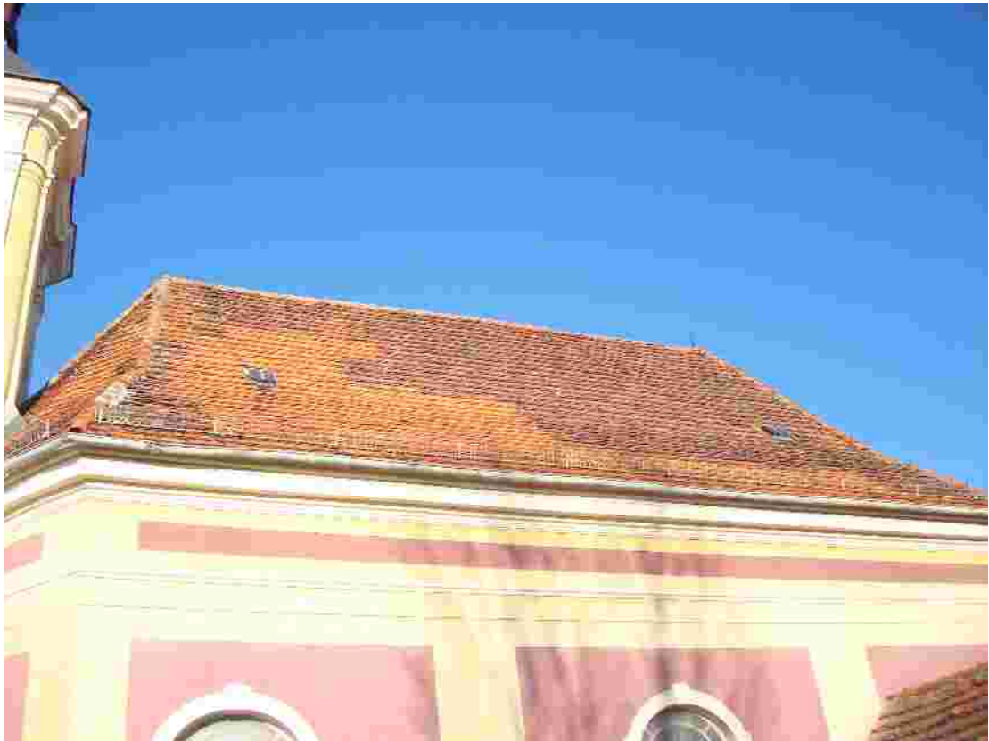
Fot.19 Stan dachu.
