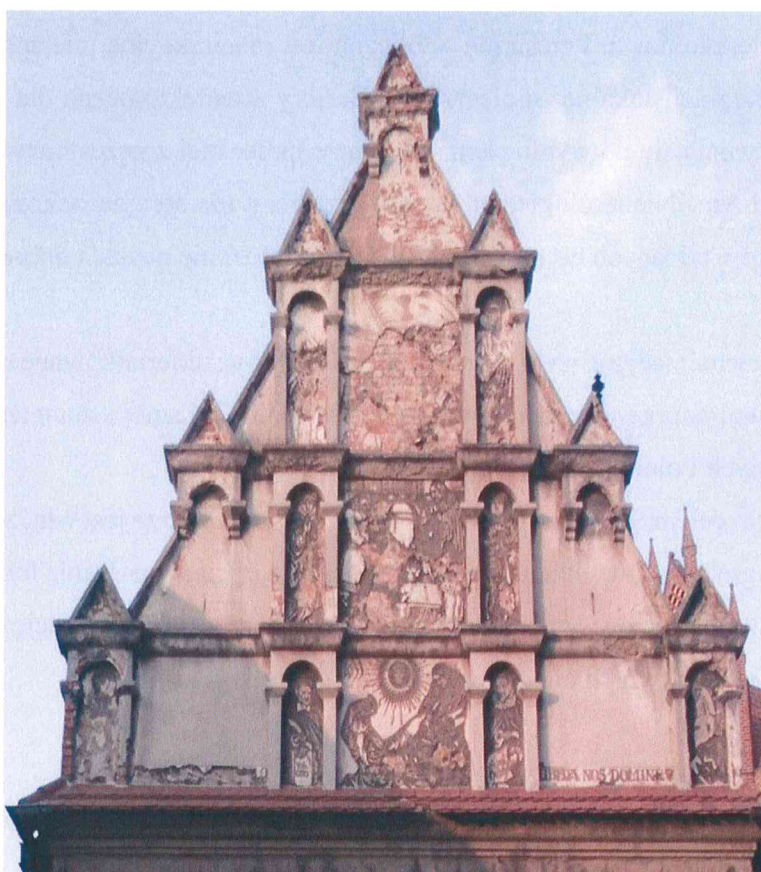
Fotografia 9 ul. Kościelna 5 – Budynek dawnej Szkoły Parafialnej, obecnie budynek mieszkalny – niszcząca sgraffita przedstawiająca m.in. patronów miasta (opr. własne).
