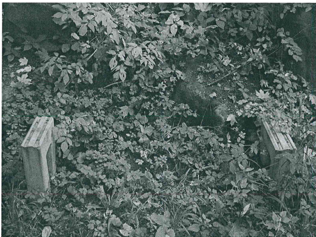
Fotografia 21 Zniszczone ławki (opr. własne).
