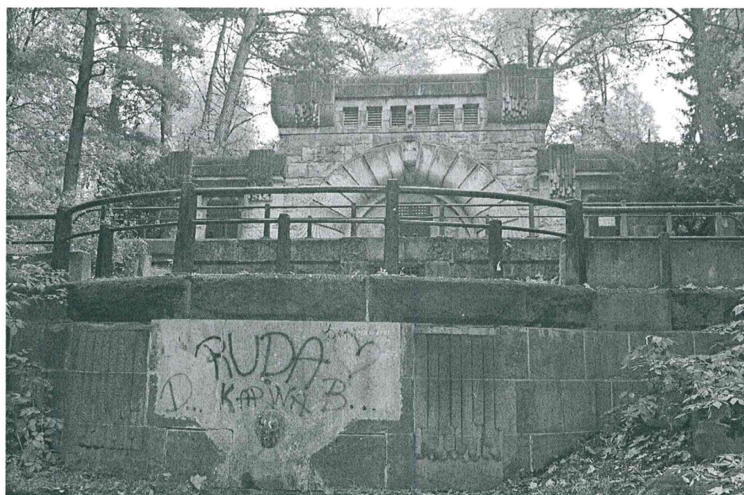
Fotografia 24 Zabytkowy „Zamek wodny” w Parku Miejskim w Żiębicach. Dawna Wieża Ciśnień. Obiekt i teren wokół jest zaniedbany i wymaga rewitalizacji (opr. własne).
