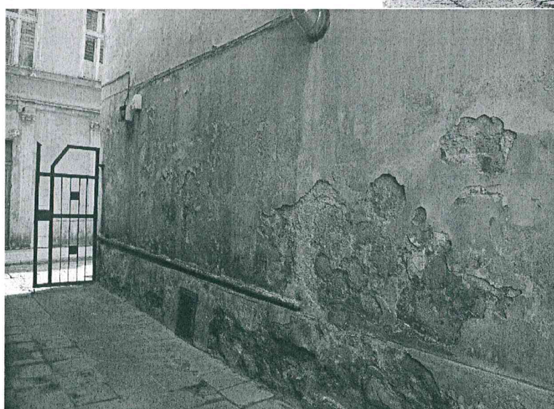
Fotografia 10 Niszczące elewacja budynków mieszkalnych w centrum miasta (opr. własne).
