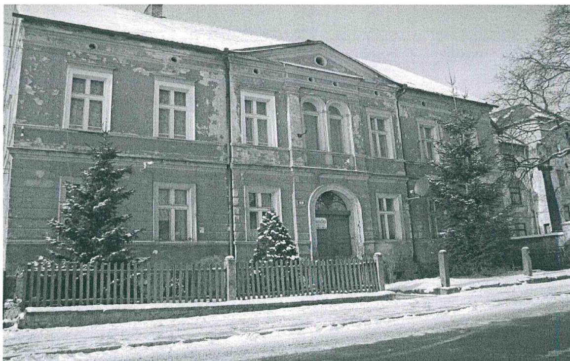
Fotografia 33 Zdegradowany budynek wielorodzinny w centrum Henrykowa ( http://www.henrykow.ziebice.pl ).
