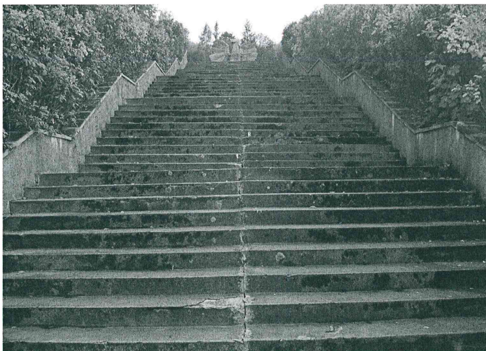
Fotografia 26 Schody prowadzące na Orła – stan obecny (opr. własne).
