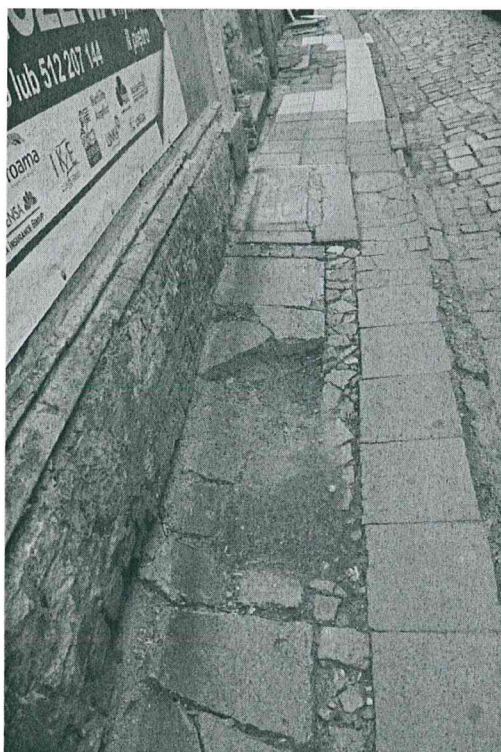
Fotografia 6 Zły stan chodników w obrębie centrum miasta (opr. własne)
