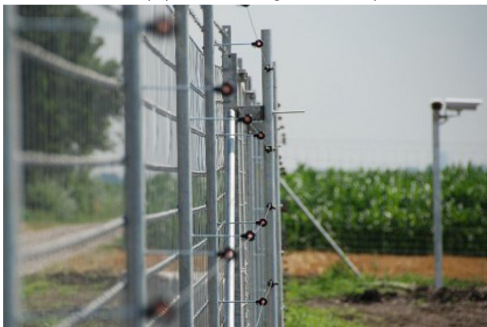
Rysunek 3: Przykładowe ogrodzenie farmy fotowoltaicznej
