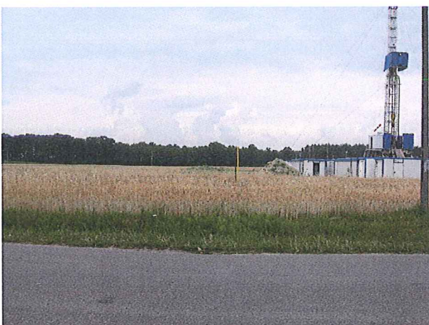
Lokalizacja odwiertu Radlin 64 - po prawej stronie zdjęcia urządzenie wiertnicze służące do likwidacji odwiertu Radlin-4
