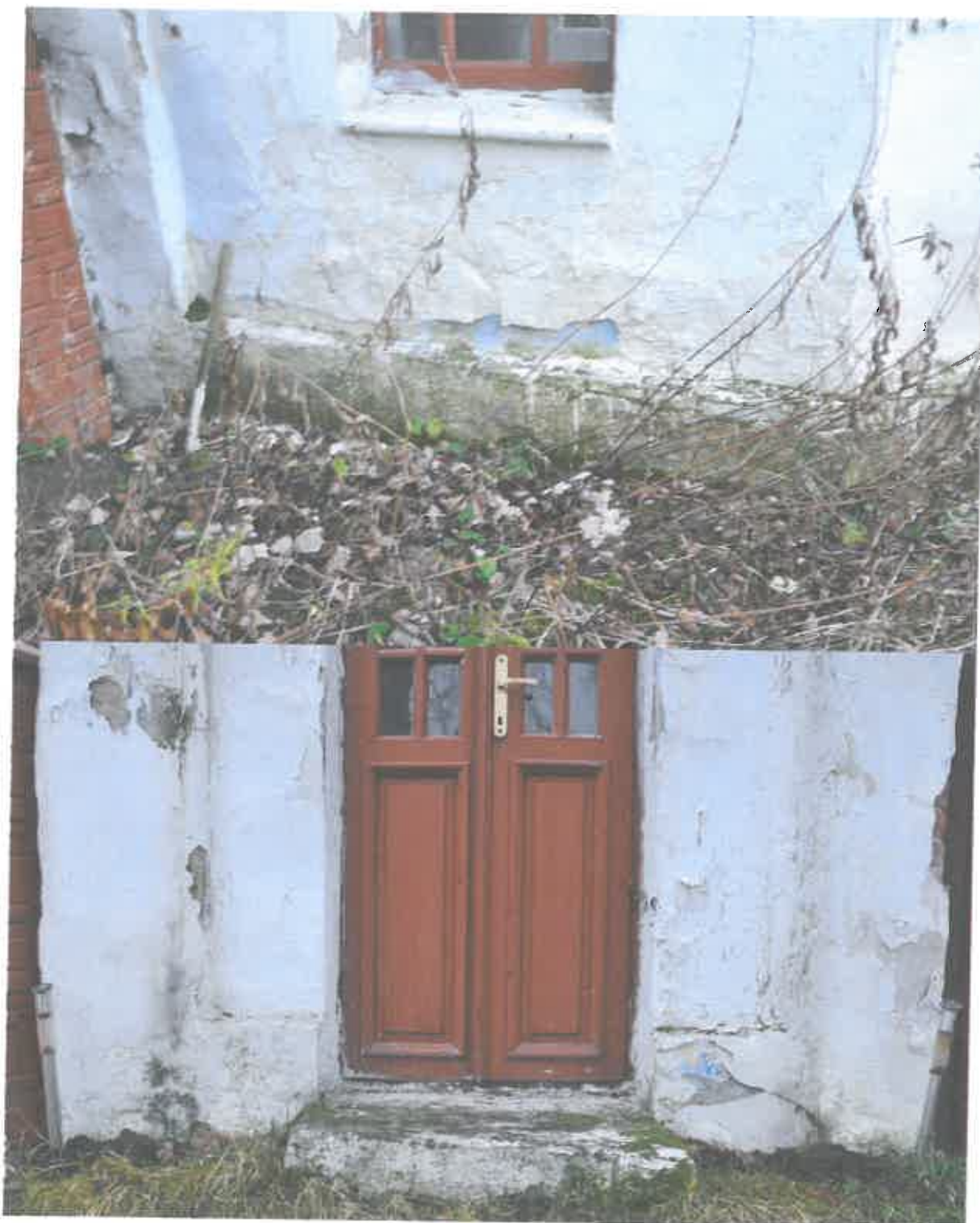
Fot. 4 Kapliczka przydrożna z przełomu XIX i XX wieku w Dzierdżiówce Stan przed konserwacją Widok złego stanu tynków e dolnych partiach ścian zewnętrznych styczeń 2018 r.
