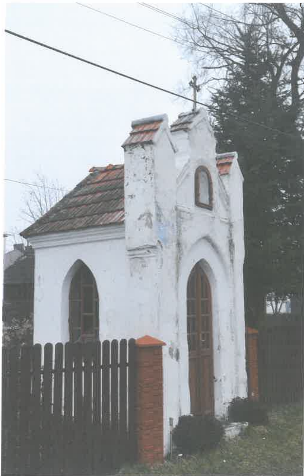
Fot. 1 Kapliczka przydrożna z przełomu XIX i XX wieku w Dzierdźwówe Stan przed konserwacją Widok całości obiektu styczeń 2018 r.
