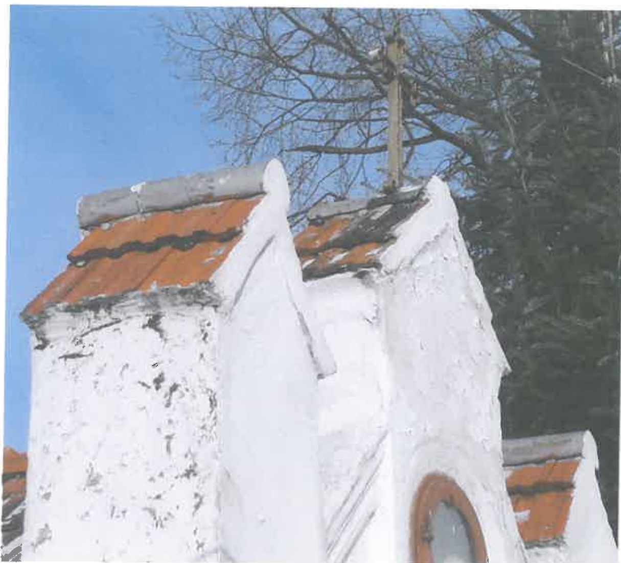
Fot. 8 Kapliczka przydrożna z przełomu XIX i XX wieku w Dzierdźwówe Stan przed konserwacją Widok neogotyckiego szczytu elewacji frontowej z tynkami w złym stanie styczeń 2018 r.
