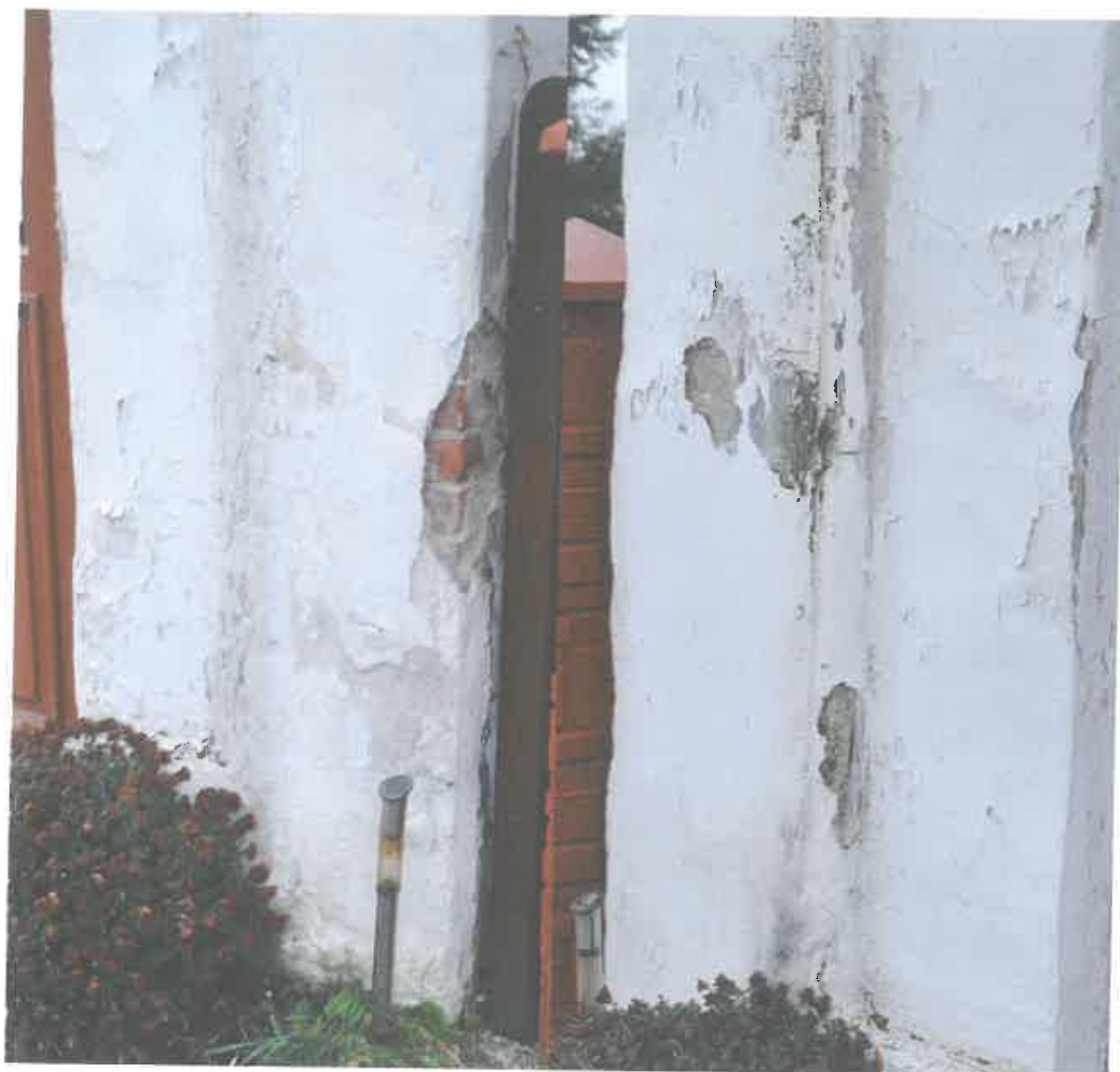
Fot. 6 Kapliczka przydrożna z przełomu XIX i XX wieku w Dzierdżiówce Stan przed konserwacją Widok złego stanu tynków e wyższych partiach ścian zewnętrznych styczeń 2018 r.
