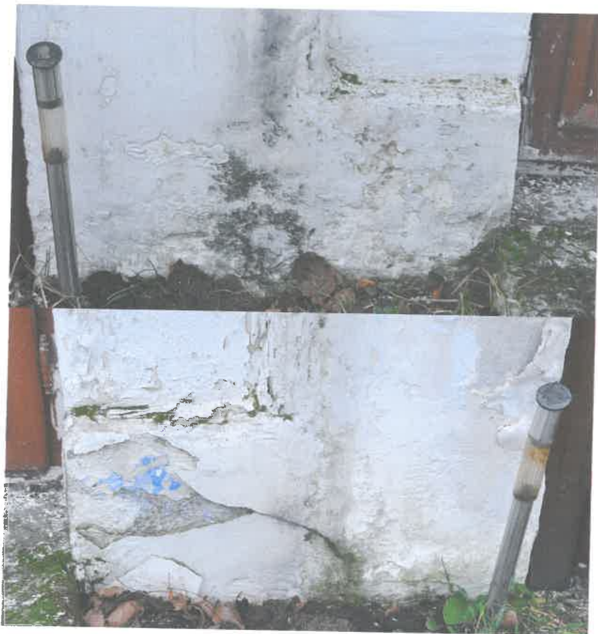
Fot. 5 Kapliczka przydrożna z przełomu XIX i XX wieku w Dzierżówce Stan przed konserwacją Widok złego stanu tynków e dolnych partiach ścian zewnętrznych styczeń 2018 r.
