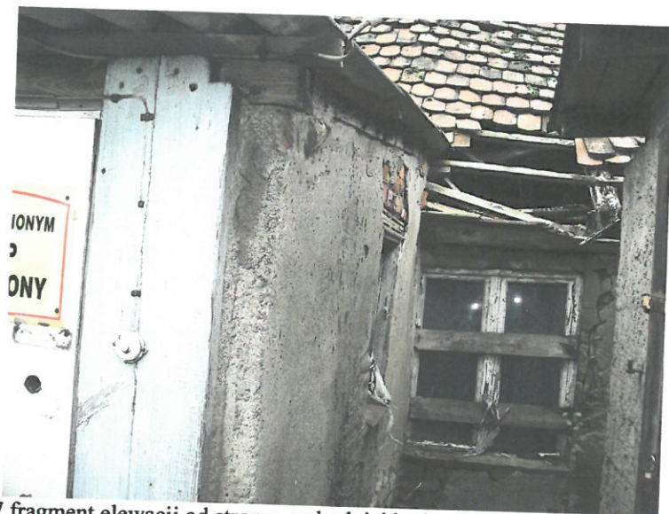
fot. 7 fragment elewacji od strony wschodniej budynek mieszkalny, a przybudówka – widoczny zarwany dach nad oknem, odkształcone spękane ściany zew. ,zły stan tech. stolarki okiennej.
