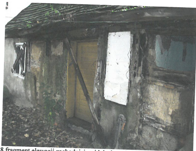
fot.8 fragment elewacji zachodniej- widok skorodowanej biologicznie ściany zew. o konstrukcji szachulcowej ,ubytki wypełnienia w ścianie
