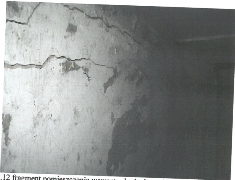
fot.11 fragment pomieszczenia wewnątrz budynku- widoczne odkształcenia, zawilgocenia, spękania ścian i sufitu, brak stolarki drzwiowej
