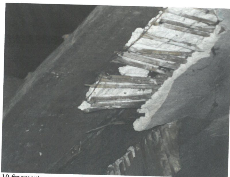
fot.10 fragment zarwanego stropu wraz z podsufitką wew. budynku mieszkalnego
