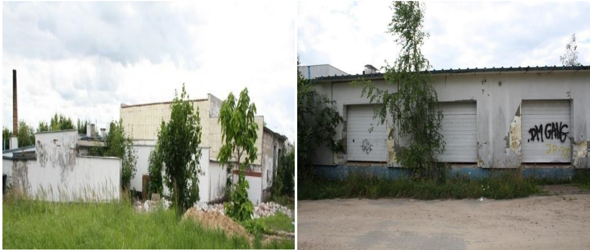
Fot. 29. Ulegające stopniowej degradacji tereny i obiekty o przeznaczeniu gospodarczym (ul. 3 Maja, Różana)
