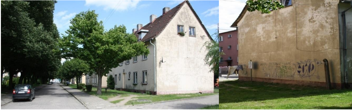
Fot. 18. Zdegradowany obiekt przeznaczony na działalność gospodarczą (ul. Parkowa)
