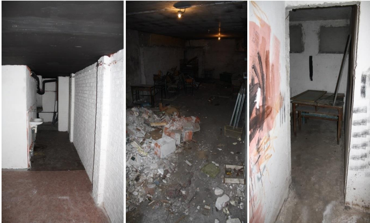
Fot. 26. Niewykorzystywane, częściowo zdegradowane pomieszczenia w piwnicach Domu Kultury – część 2.
