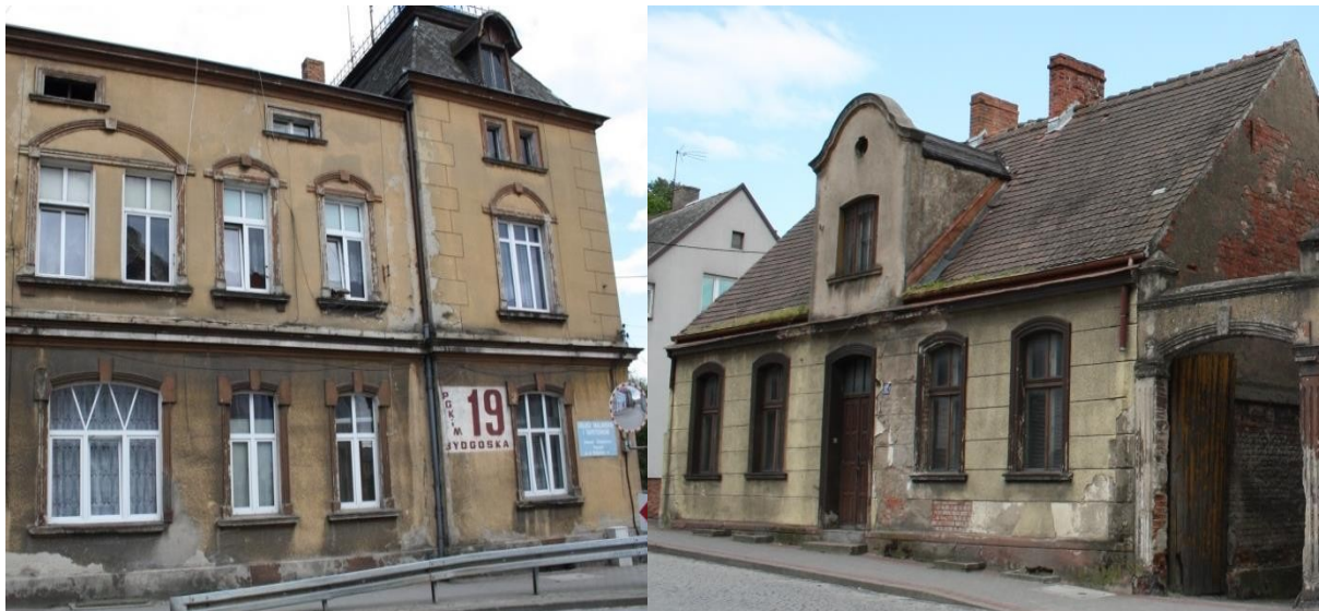
Fot. 21. Zdegradowane budynki mieszkalne (ul. Bydgoska)
