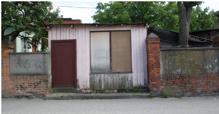
Fot. 18. Zdegradowany obiekt przeznaczony na działalność gospodarczą (ul. Parkowa)
