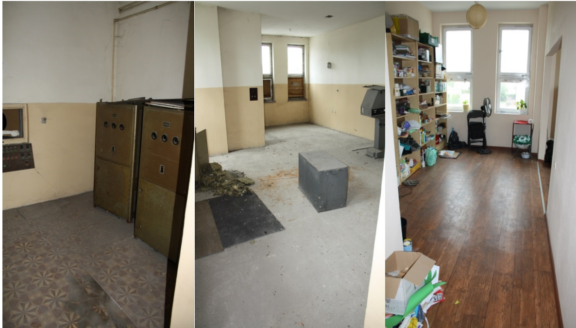
Fot. 27. Niewykorzystywane, częściowo zdegradowane pomieszczenia na piętrze tzw. Domu Kultury
