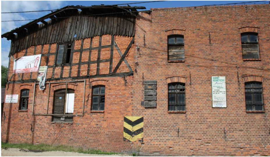
Fot. 22. Zdegradowany budynek byłego młyna (ul. Staszica)
