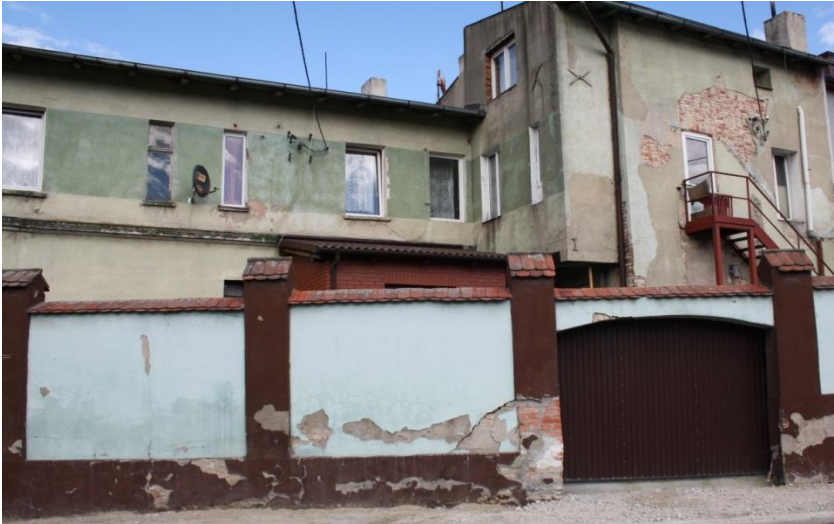
Fot. 19. Zdegradowane budynki mieszkalne (ul. 22 Stycznia)
