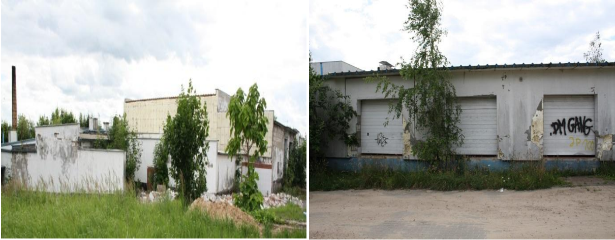
Fot. 29. Ulegające stopniowej degradacji tereny i obiekty o przeznaczeniu gospodarczym (ul. 3 Maja, Różana)
