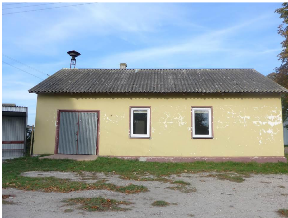
Zdjęcie 51 Budynek Ochotniczej Straży Pożarnej w Olbrachcicach. fot. GRACZKOWSKI DOTACJE Sp. z o.o., październik 2015.
