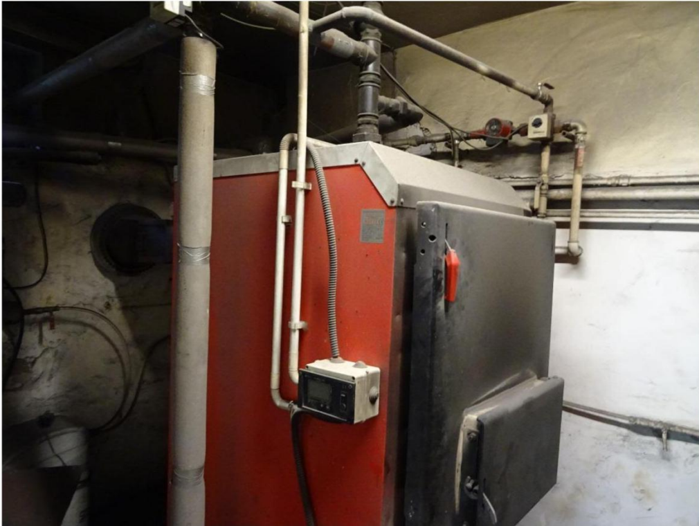
Rysunek 6. Zainstalowany kocioł węglowy.
