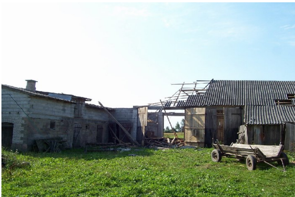
Zniszczenia spowodowane przez huragan Dąbrowie – Łazach.
