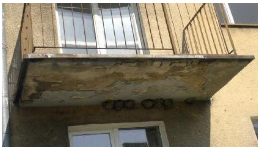
Fot. 2 Płyta balkonu od strony spodniej
