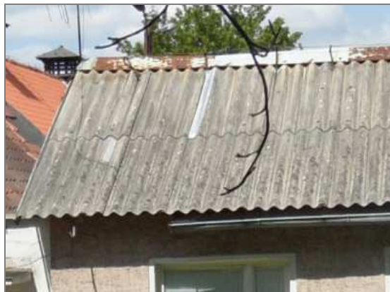
Fot.1 Płyty azbestowo-cementowe faliste
