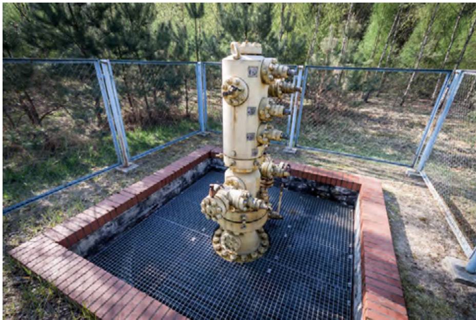
fot. 2. Głowica odwiertu Czarna Wieś-4
