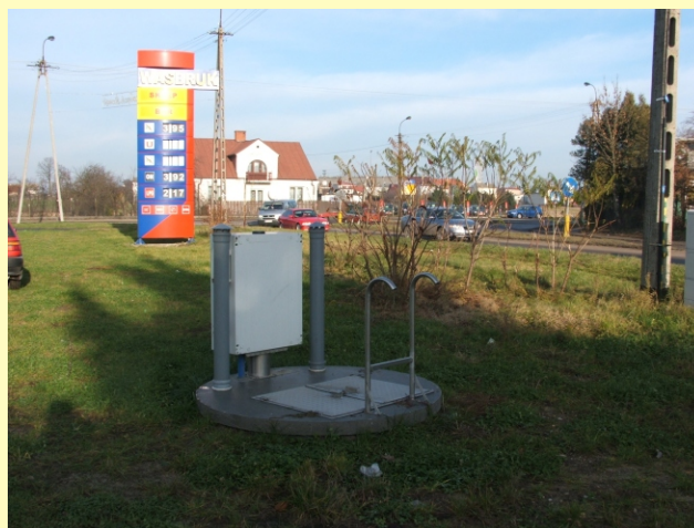
Kanalizacja sanitarna w ul. Szosa Ciechanowska - przepompownia ścieków
