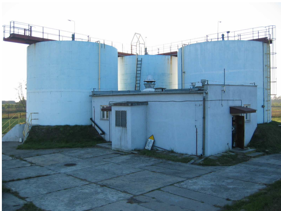
Fot. 27 Oczyszczalnia ścieków w Watkowicach komory osadu czynnego
