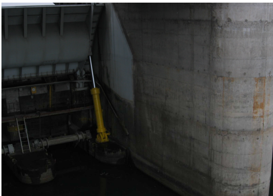
Fot. 22 Elektrownia wodna przy Zbiorniku Jeziorsko
