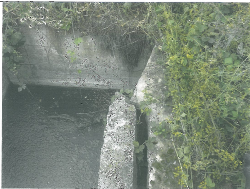
2. Obiekt nr1 - uszkodzenia przy końcu zachodnim.
