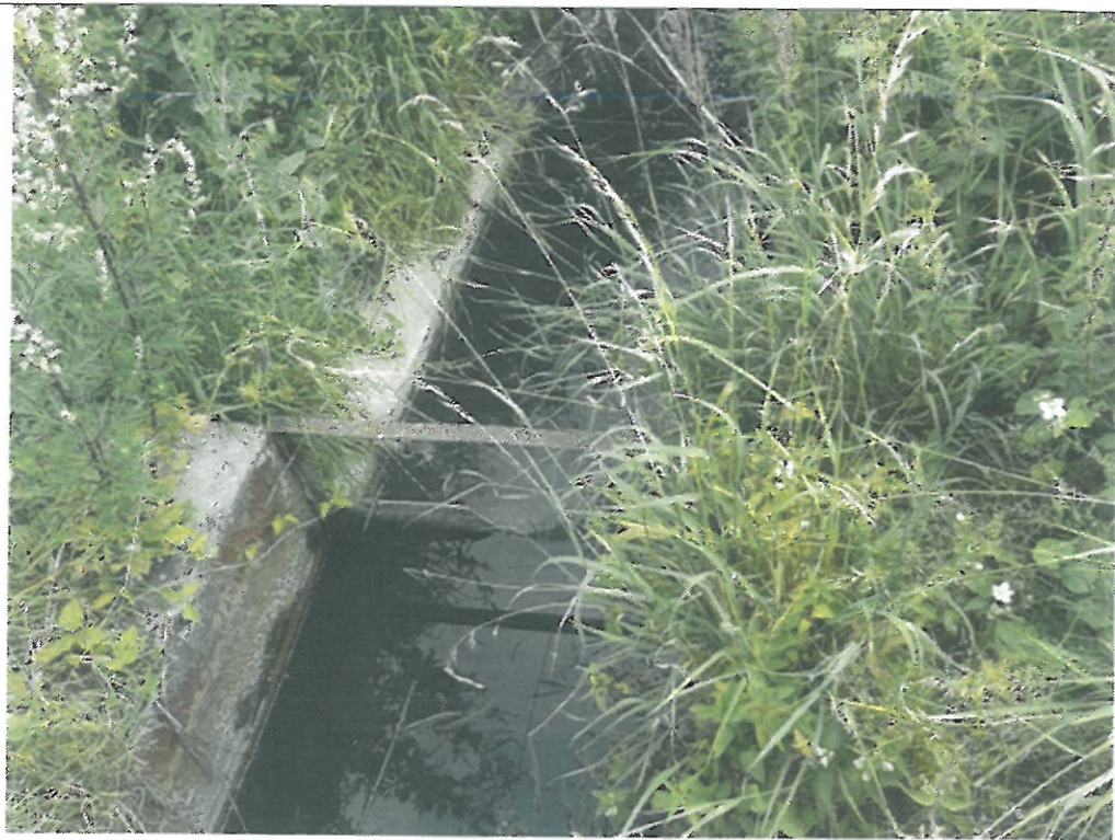
8. Obiekt nr1 - zastawka na rowie odpływowym.
