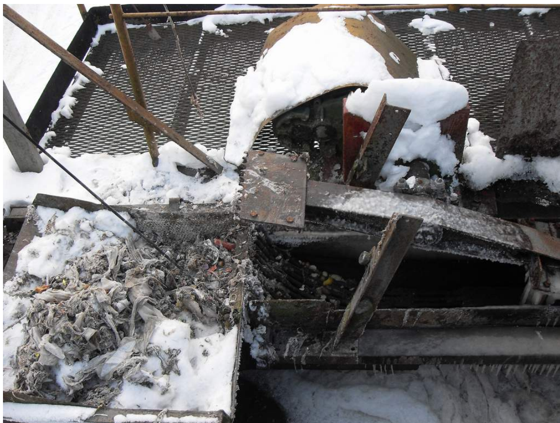
Zdjęcie nr 1. Krata łukowa na oczyszczalni ścieków w Chociczy.
