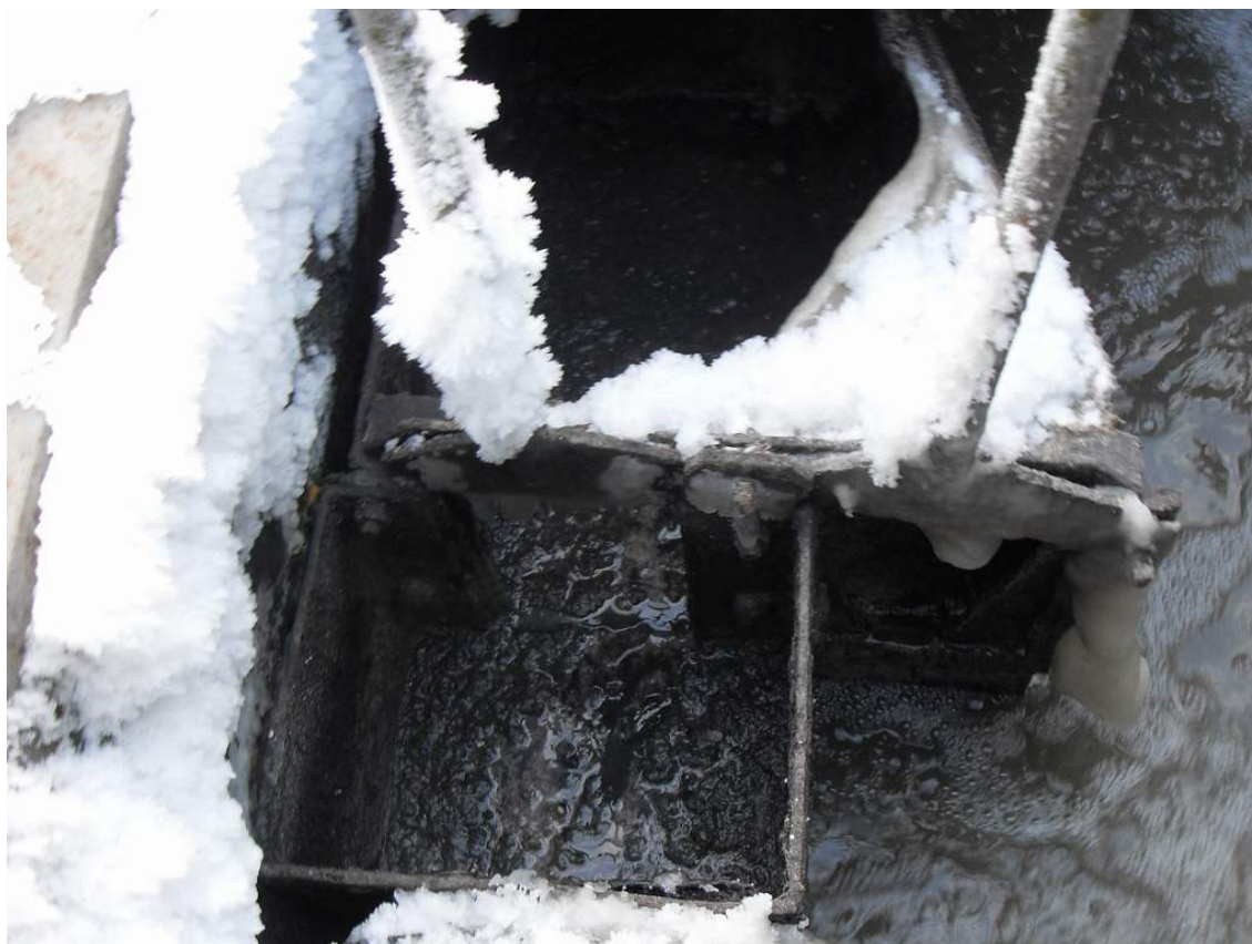
Zdjęcie nr 2. Uszkodzone zastawki na korytach rozdziału ścieków.
