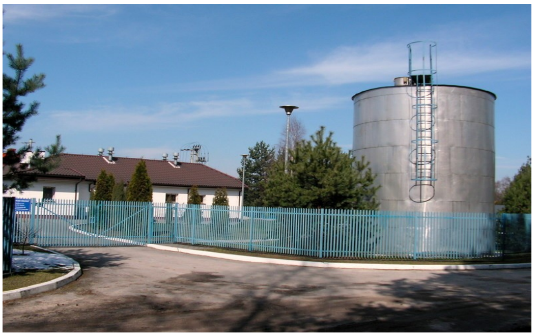
Fot. 1. Ujęcie wody w Woli Kopcowej
