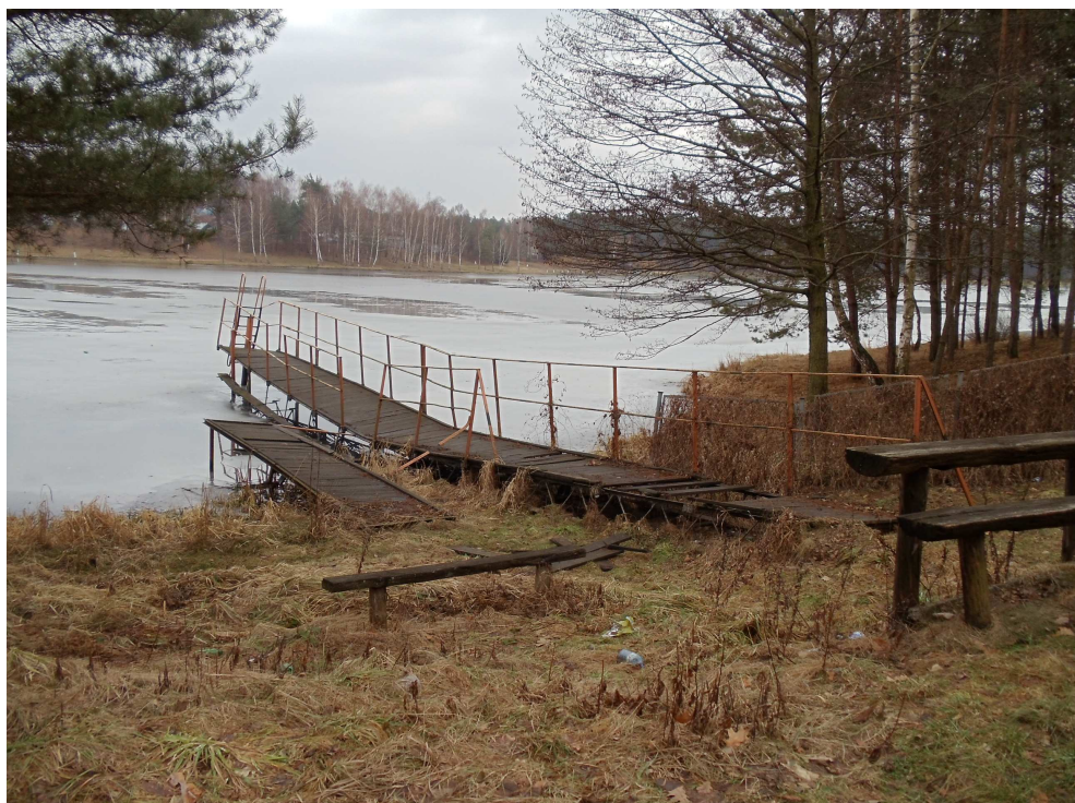
foto 3. zniszczony pomost w północno-zachodniej części zalewu - stan obecny
