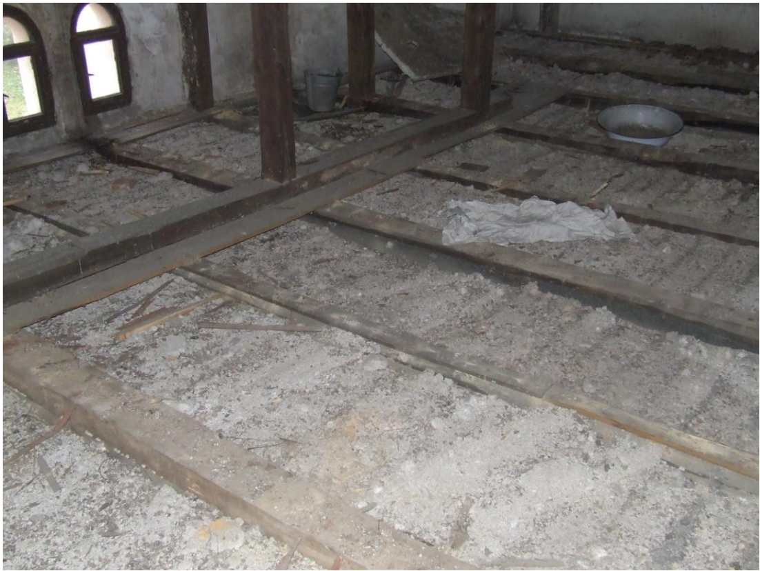
Fot.20. Strop nad 1 piętrem w części prawej.
