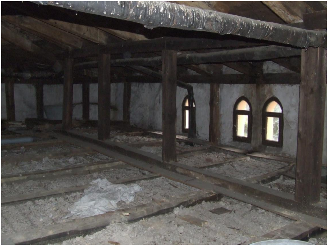
Fot.22. Strop nad 1 piętrem w części prawej.
