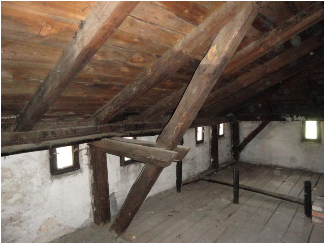
Fot.4. Wiązar główny - strefa przy słupach skrajnych.
