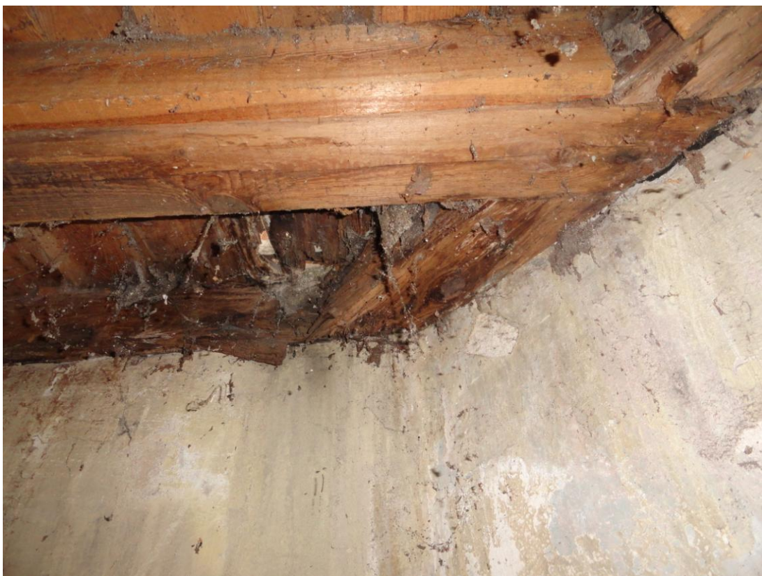
Fot.12. Strop wieży - korozja belek i poszycia przy ścianie zewnętrznej.
