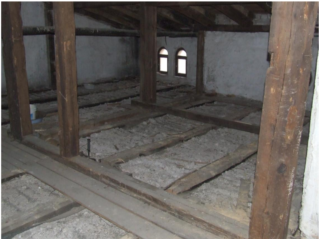
Fot.21. Strop nad 1 piętrem w części prawej.
