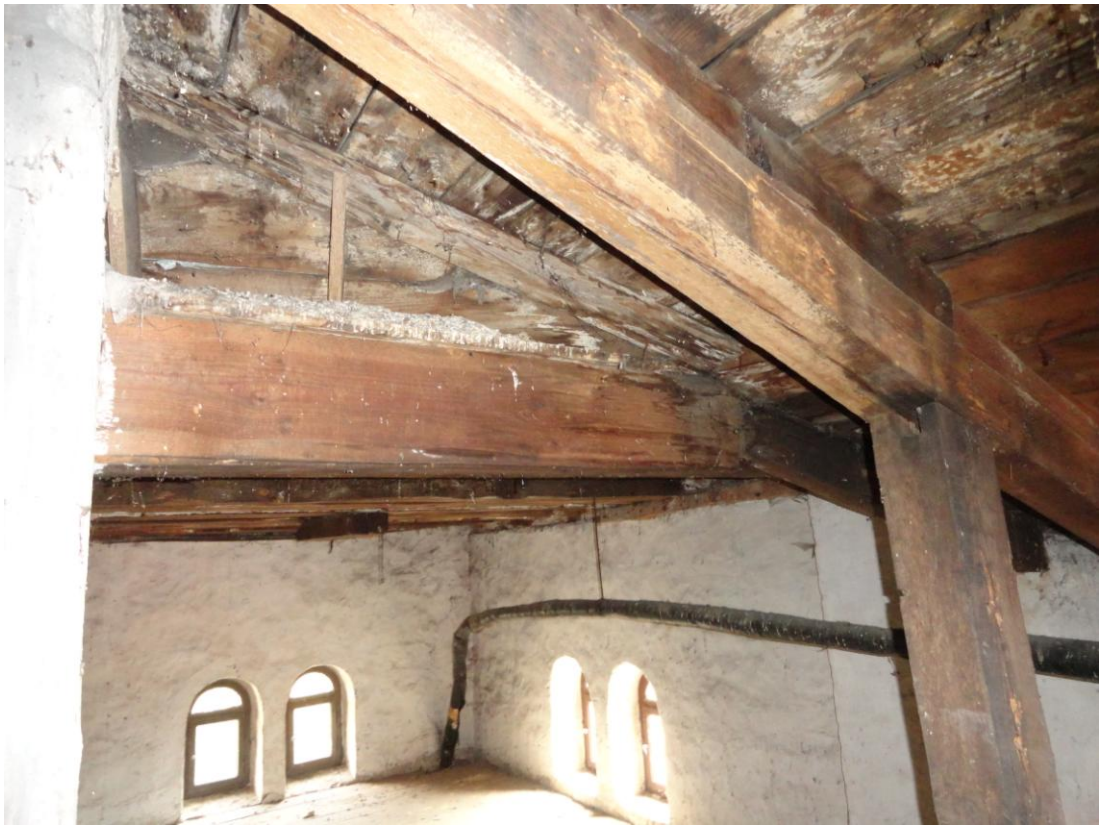
Fot.10. Całkowite zawilgocenie strefy styku połaci dachowych
