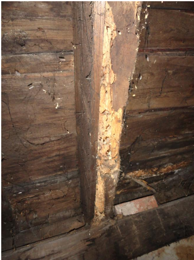
Fot.5. Zaawansowana korozja krokwi i posycia w strefie przypodporowej.
