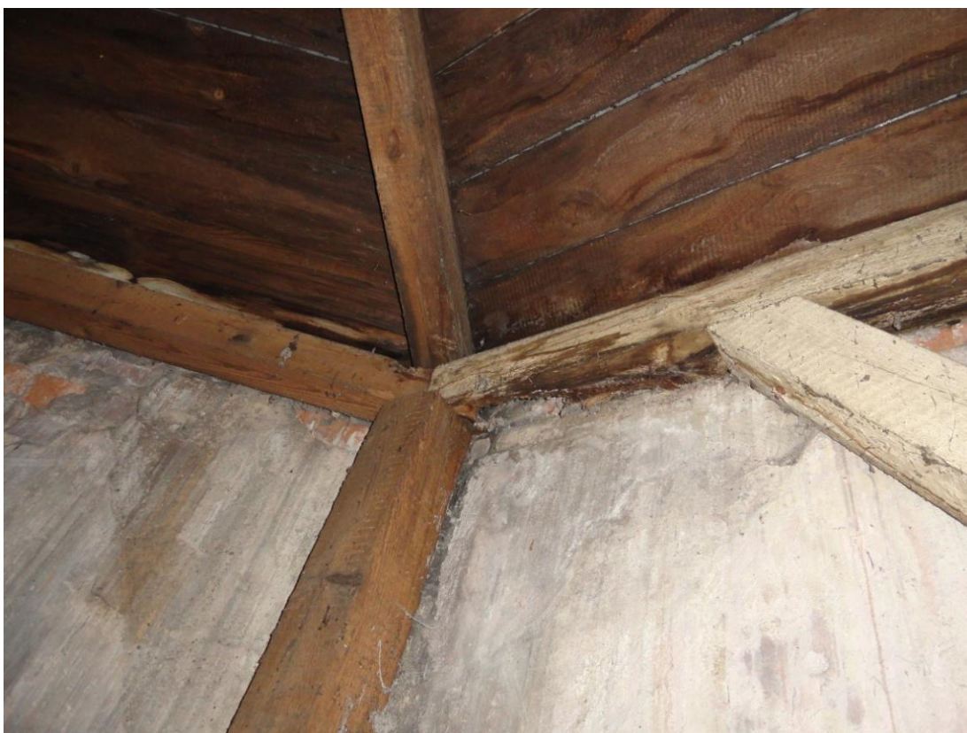
Fot.15. Strop wieży - korozja elementów drewnianych w strefie przyściennej.
