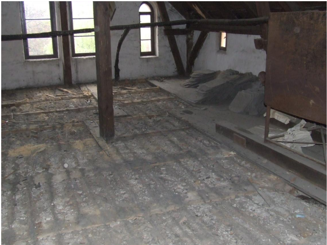
Fot.24. Strop nad 1 piętrzem w części środkowej.
