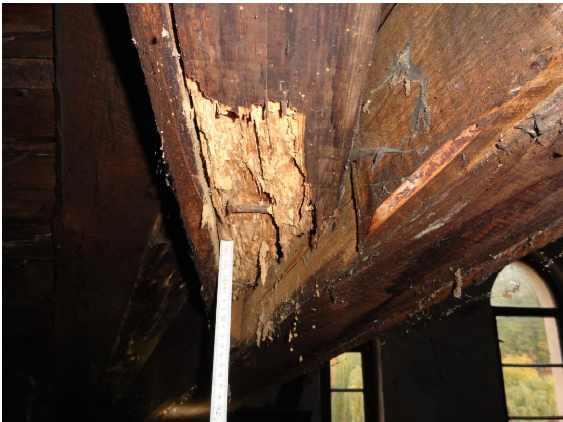
Fot.19. Korozja krokwi przy krokwi koszowej.
