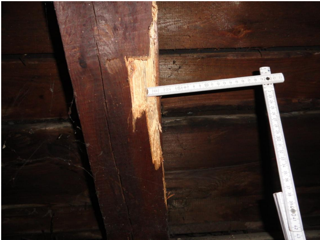
Fot.16. Krokiew - ubytek przekroju ze względu na korozję biologiczną na powierzchni bocznej - około 1-2cm.
