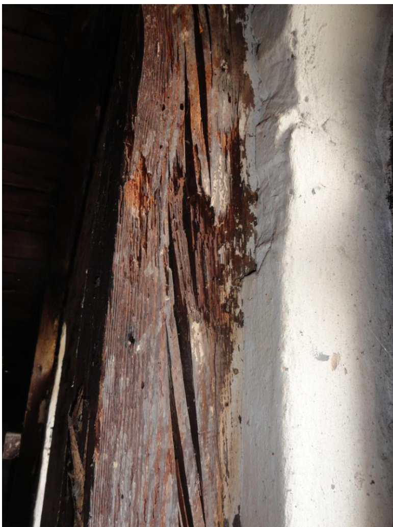
Fot.6.Korozja słupa głównego w strefie przy ścianie zewnętrznej.
