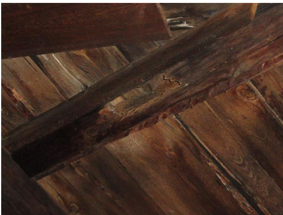
Fot.7.Ubytek przekroju krokwi.
