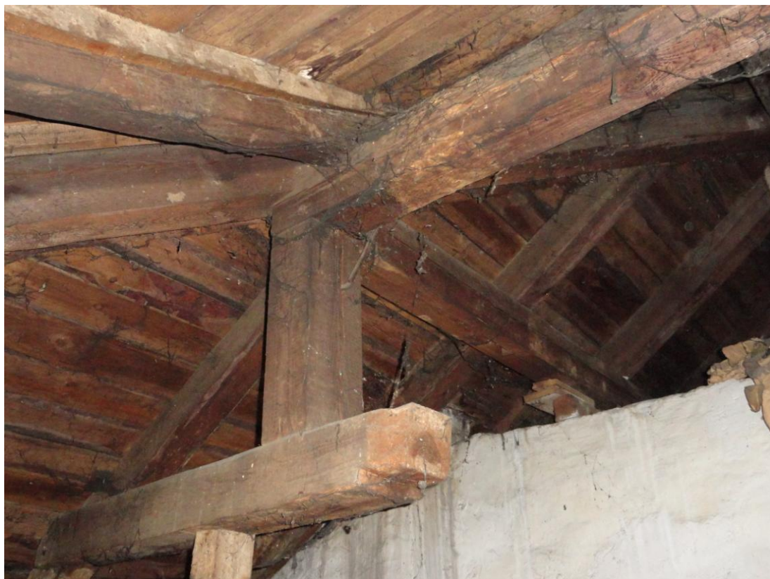
Fot.1. Tymczasowo podparty narożnik płatwi głównej - układ niezapewniający stateczności w miejscu głównego podparcia.
