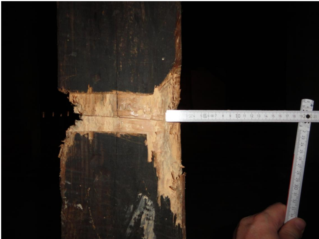
Fot.18. Słup główny - ubytek przekroju ze względu na korozję biologiczną około 1-2cm.
