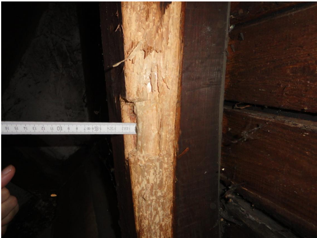
Fot.17. Krokiew - ubytek przekroju ze względu na korozję biologiczną na powierzchni dolnej - około 1-2cm.
