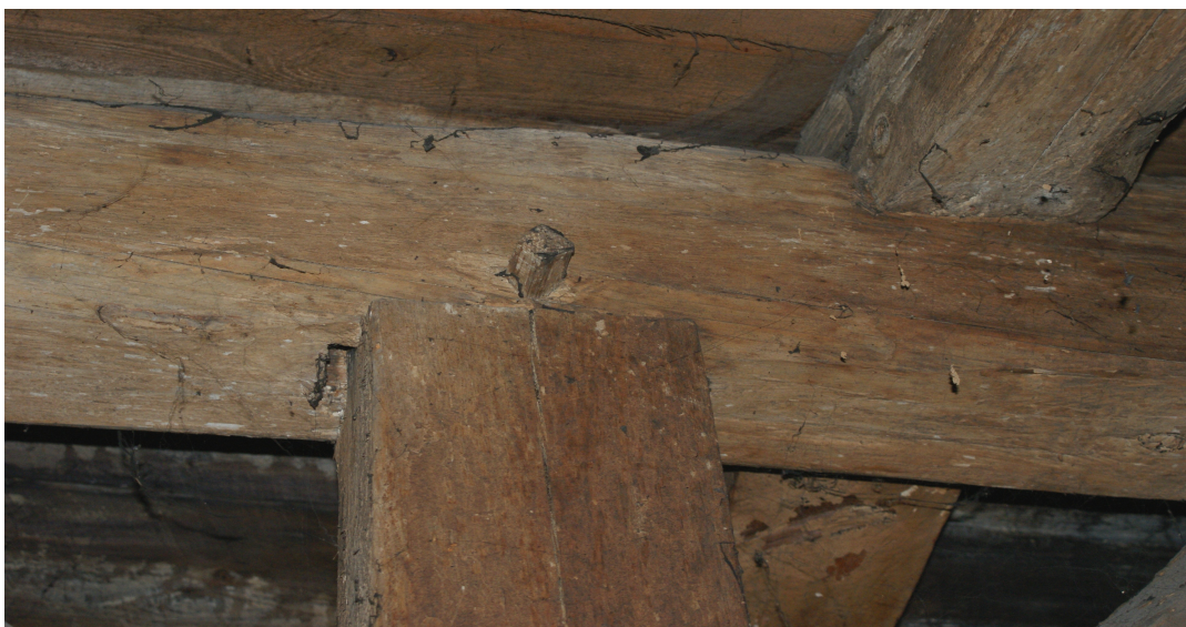
Fot. 7 Kaźmierz , pałac – fragm. pierwotnej oryginalnej konstrukcji dachowej,łączenia ciesielskie wzmacniane kolkami drewnianymi.
