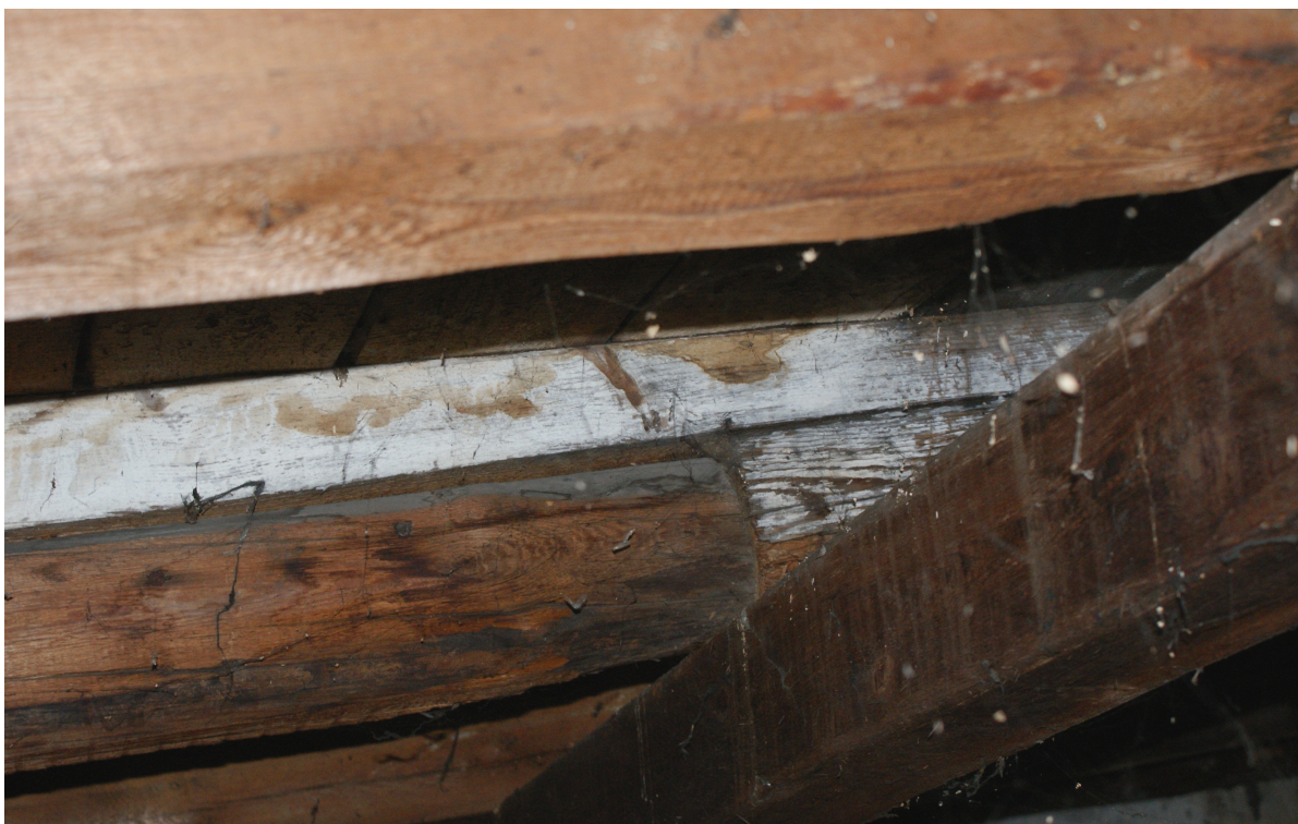
Fot 16,17 Kaźmierz , pałac – konstrukcja dachowa , widoczne uzupełnienia na styk bez łączy ciesielskich.
