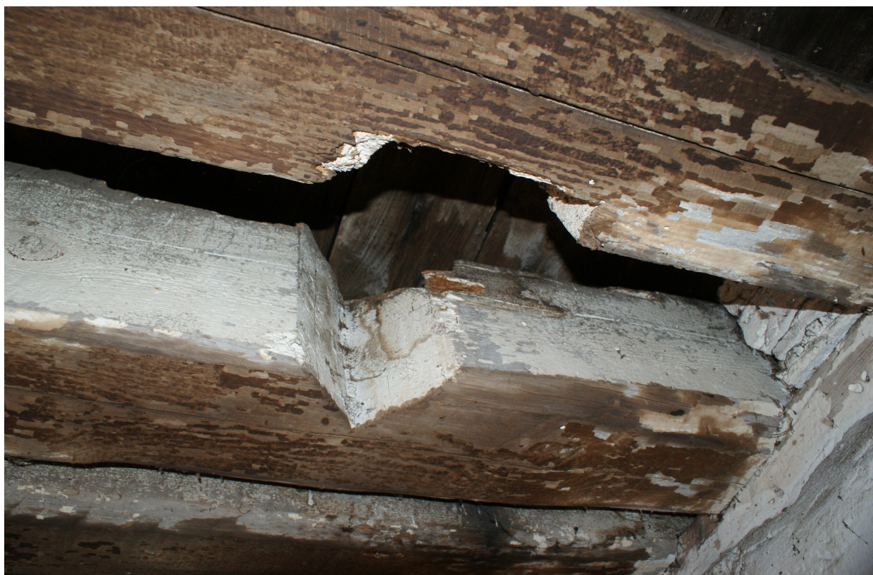
Fot.14,15 Kaźmierz , pałac – nieliczne zachowane belki oryginalnej konstrukcji dachowej obiektu.
