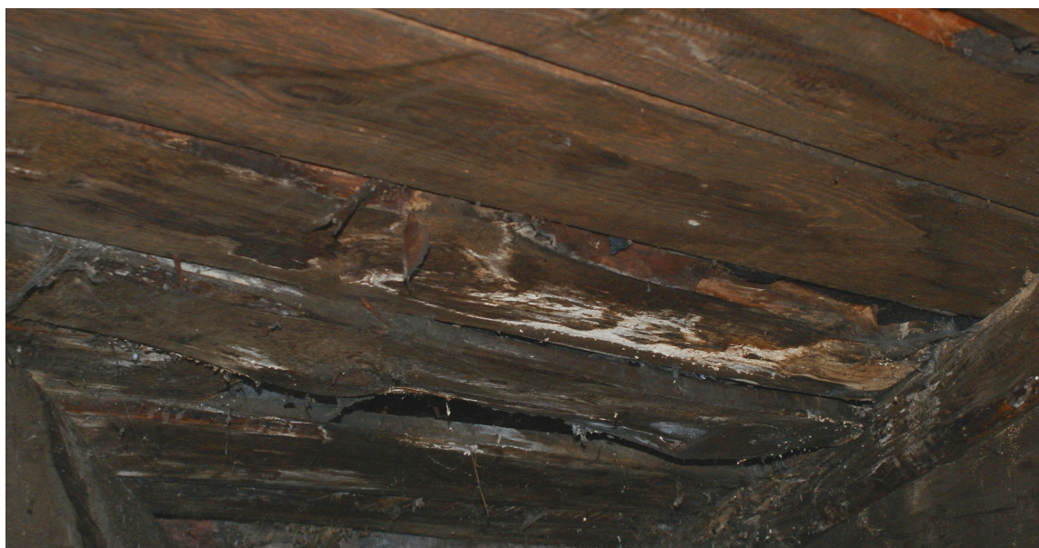
Fot. 9 Kaźmierz , pałac – konstrukcja dachowa , uszkodzenia tkanki drzewnej wskutek oddziaływania grzybów domowych.
