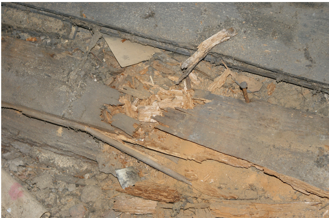
Fot. 10 Kaźmierz , pałac – belki stropowe, uszkodzenia tkanki drzewnej wskutek oddziaływania grzybów domowych, rozkład przyzmatyczny.
