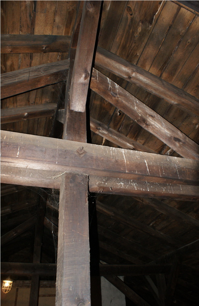
Fot. 5 Kaźmierz , pałac – wtórna konstrukcja dachowa, widoczne śruby łączące elementy składowe więźby.
