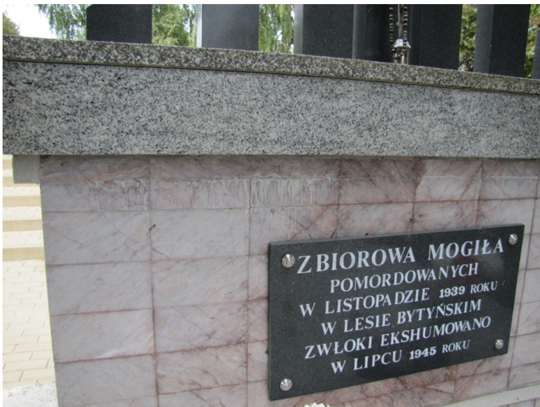
Fot. 3 Zbliżenie na okładzinę marmurową. Widoczne zabrudzenia z zapraw i nieestetyczne spoiny. Widoczna także współczesna tablica i granitowe obramienie pod nakrywą.
