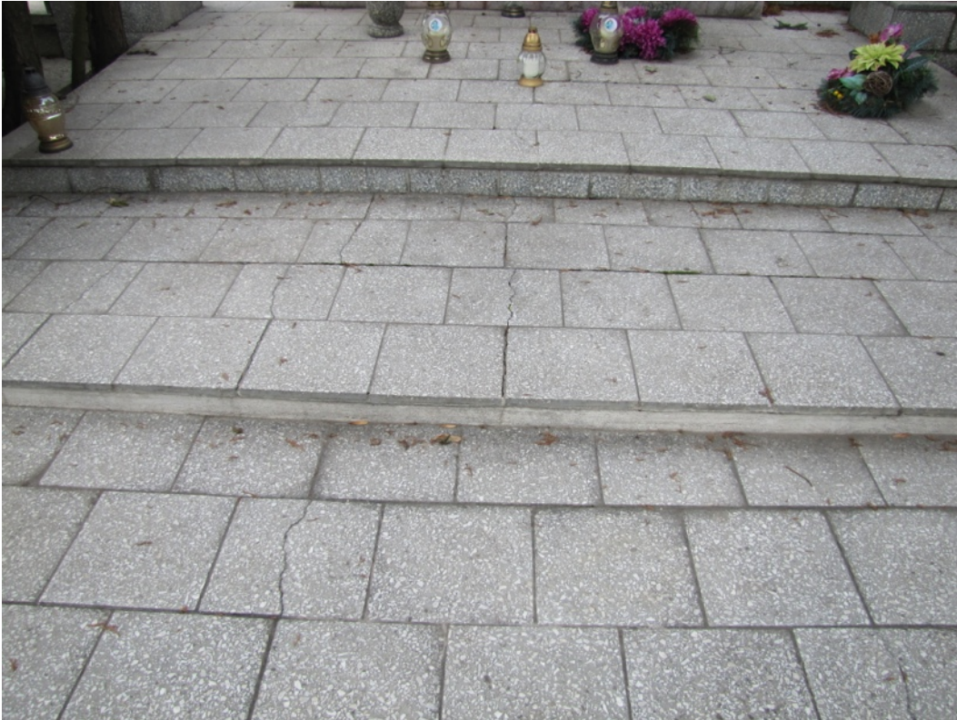
Fot. 7 Trójstopniowy podest przed pomnikiem. Widoczne zabrudzenia i spękania okładziny z płytek z lastriko. Widoczny także brak okładziny jednej z podstopnic.
