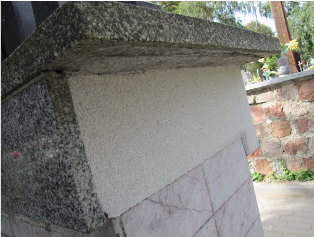
Fot. 5 Zbliżenie na tynk marmurkowy na bokach głównego założenia pomnikowego, do usunięcia.
