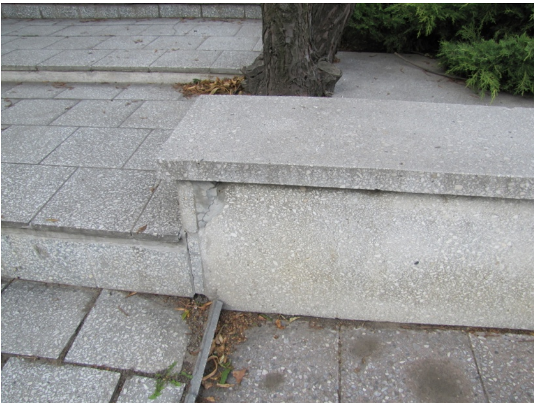
Fot. 8 Zbliżenie na murek z lastriko. Widoczny ubytek w formie wyprawiony zaprawą cementową.
