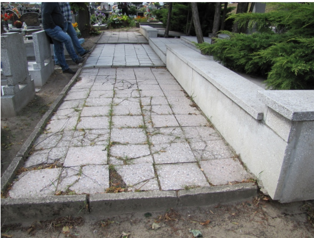
Fot. 6 Dolne podesty pomnika z okładziną z lastriko. Widoczne silne uszkodzenia płytek i brak jednego poziomu posadzki.
