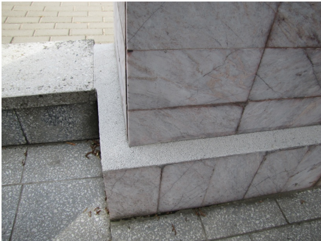
Fot. 4 Zbliżenie na tynk marmurkowy na rolce cokołowej, do usunięcia.
