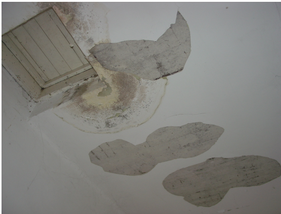
Odpadają płatki tynku ze stropu przy wy³azie na dach
