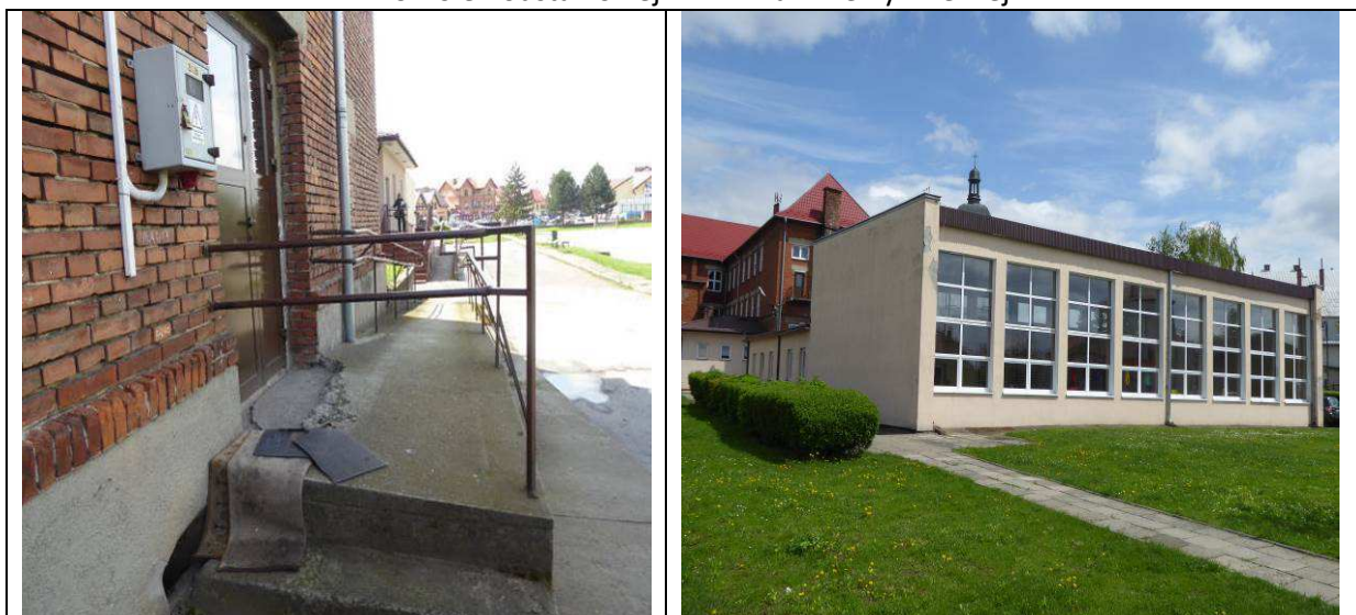
Zdjęcie 12 Stan aktualny podjazdów dla niepełnosprawnych oraz elewacji budynku Sali gimnastycznej w Szkole Podstawowej nr 1 w Kazimierzy Wielkiej
