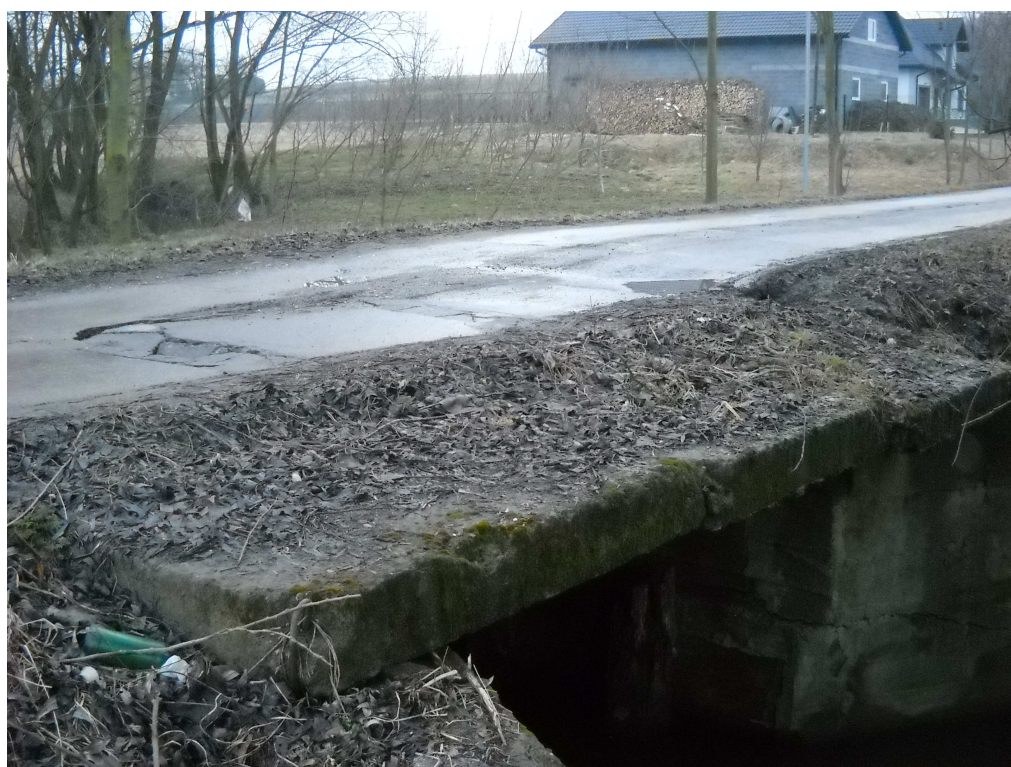
FOT. 11 Widok mostu od góry na uszkodzenia środkowej części płyty mostowej
