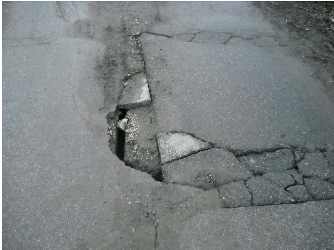
FOT. 6 Uszkodzona płyta mostu (rozwarstwienie istn. płyt drogowych w osi jezdni)
