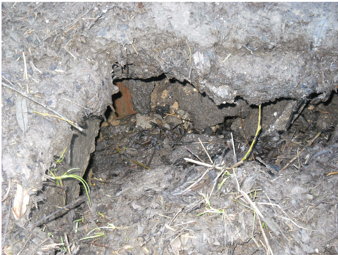
FOT. 14 Widok mostu od góry na uszkodzone, rozmyte skarpy obok przyczółków - str. lewa
