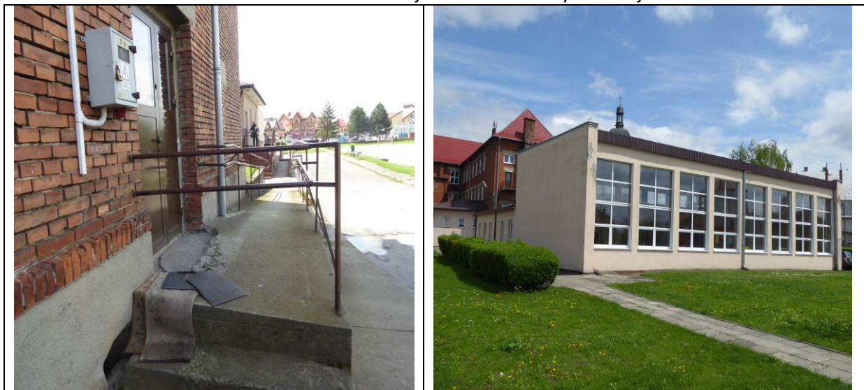
Zdjęcie 12 Stan aktualny podjazdów dla niepełnosprawnych oraz elewacji budynku Sali gimnastycznej w Szkole Podstawowej nr 1 w Kazimierzy Wielkiej
