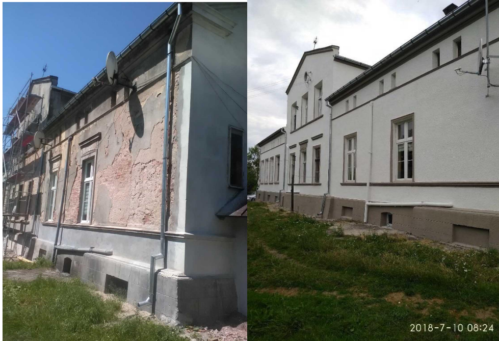
Fot. 6.4. Budynek w Konojadach 107 przed i po remoncie (źródło: UMiG Jabłonowo Pomorskie)
