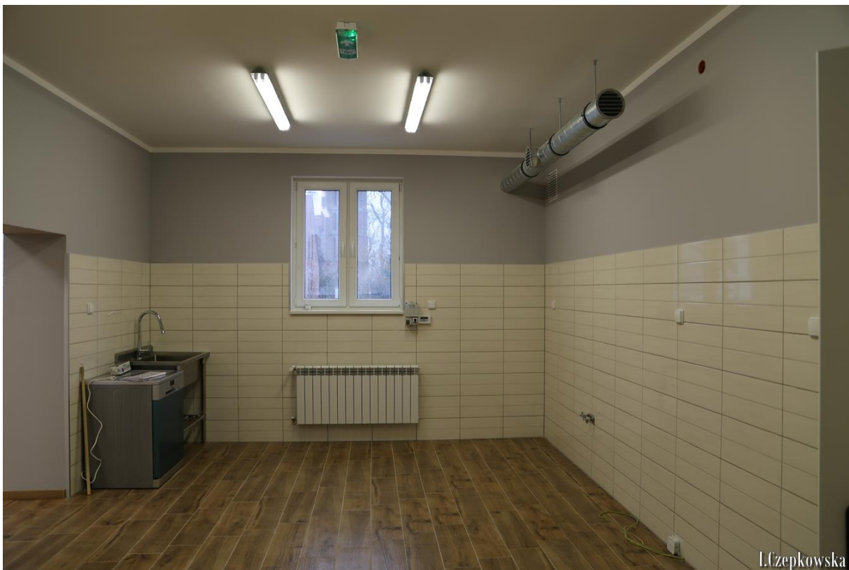
Fot. 4.16. Zmiana sposobu użytkowania części budynku użyteczności publicznej (świetlica w Lembargu) na pomieszczenia techniczne (kotłownię) wraz z jego przebudową i termomodernizacją (źródło: UMiG Jabłonowo Pomorskie)
