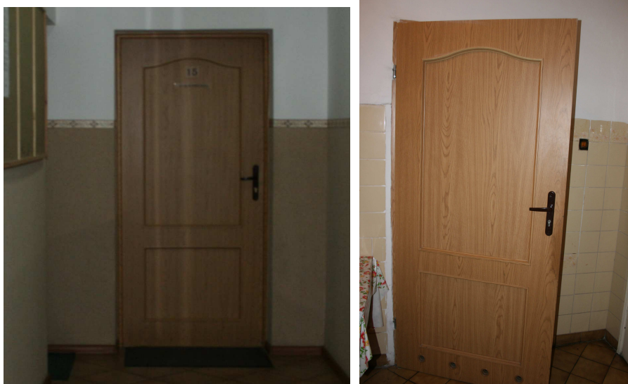
Fot.24, 25. Wymieniona stolarka drzwiowa – drzwi do pokojów administracyjnych pełne, drzwi łazienkowe – z otworami wentylacyjnymi.
