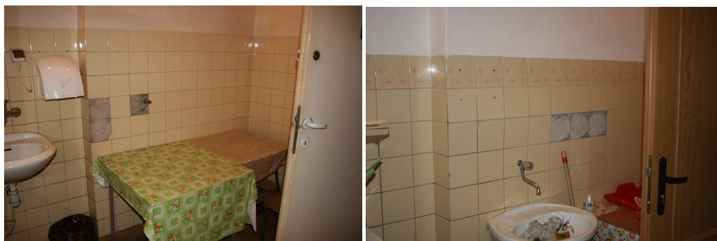
Fot. 15, 16, 17, 18. Toalety na różnych kondygnacjach – część nieodnowiona: zróżnicowane, zniszczone, z ubytkami posadzki i okładziny ścian, zróżnicowane drzwi wewnętrzne, brak rozdziału na osobną toaletę dla kobiet i mężczyzn, brak toalety dla osób niepełnosprawnych.
