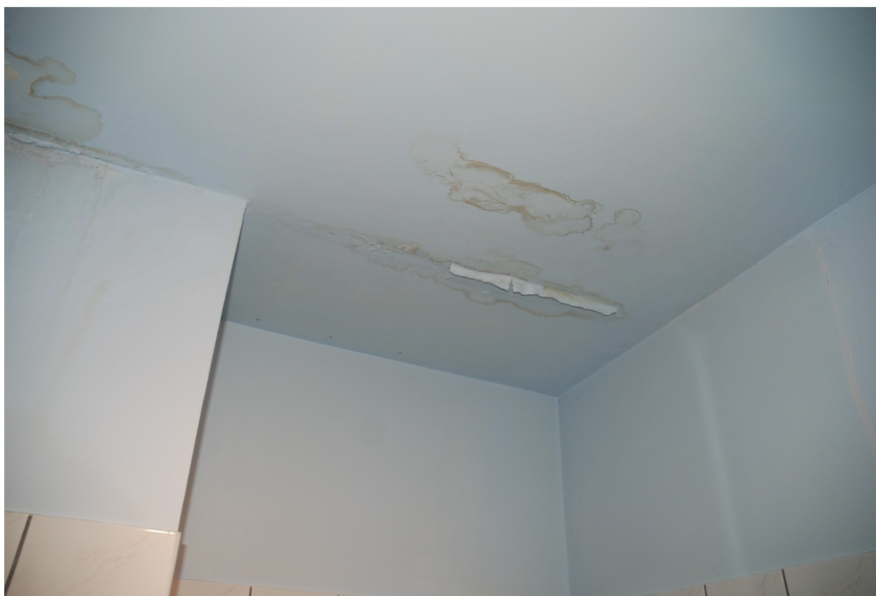
Fot. 4. Zawilgocenia sufitów w mieszkaniach na poddaszu budynku
