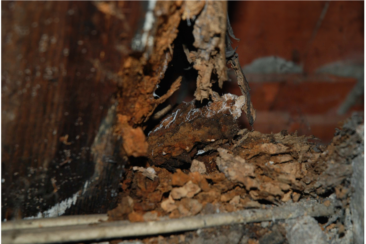
Fot. 5. Widok fragmentu krokwi uszkodzonej w wyniku korozji biologicznej – rozkład brunatny drewna porażonego grzybem domowym
