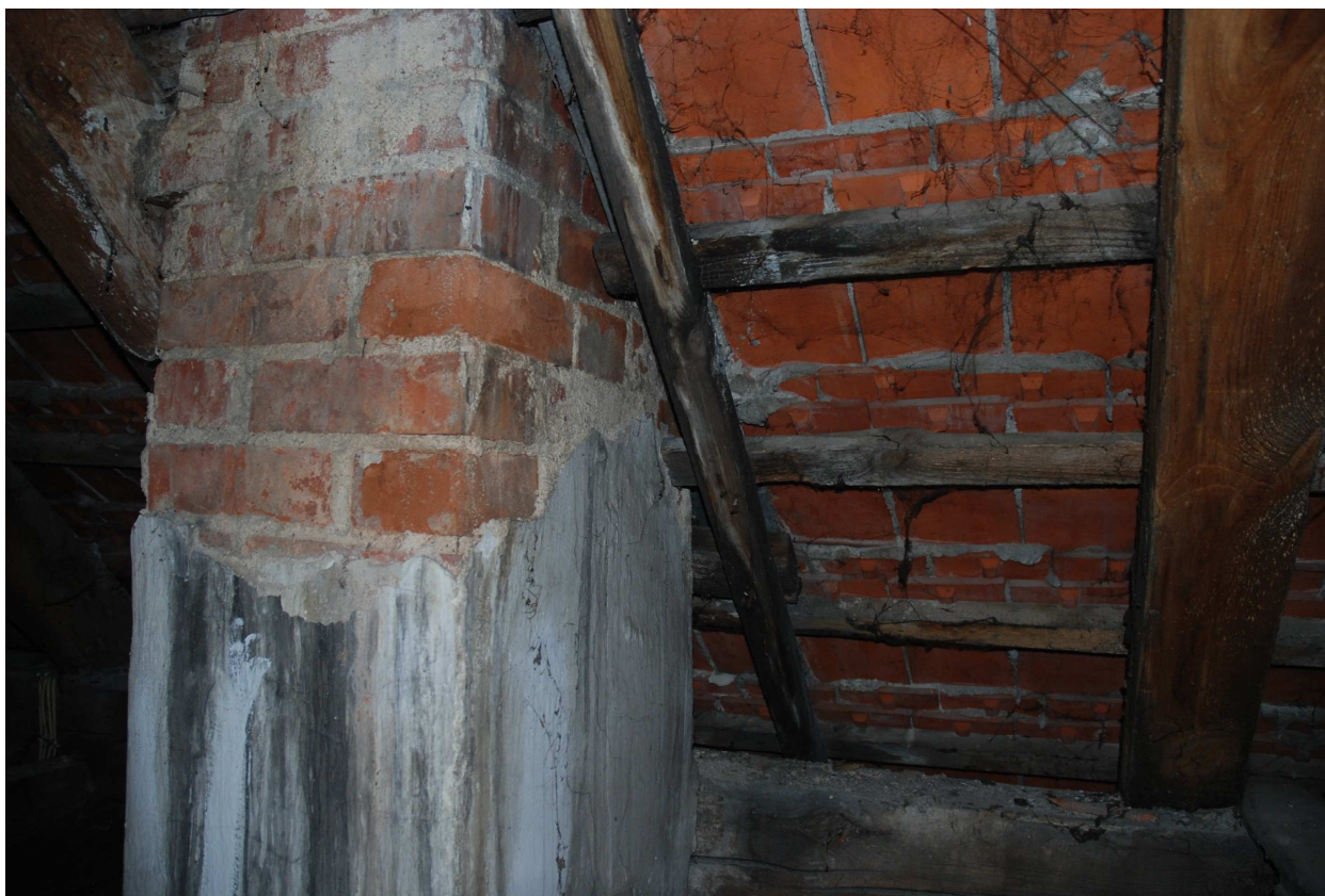
Fot. 3. Widok przykładowych uszkodzeń na poddaszu w wyniku zawilgocenia od nieszczelności obróbek blacharskich kominów i pokrycia
