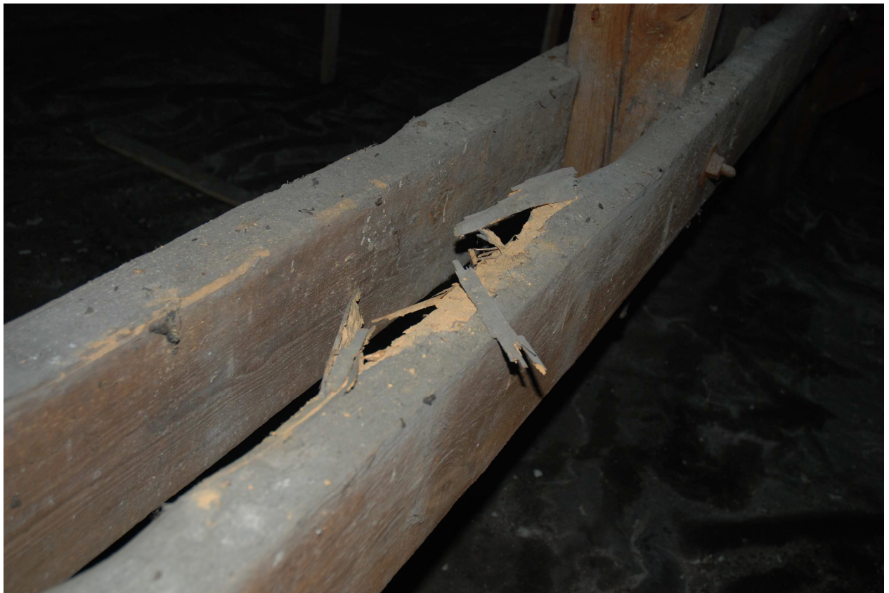
Fot. 6. Widok uszkodzonych kleszczy konstrukcji dachu – porażenie owadami ksylofagicznymi
