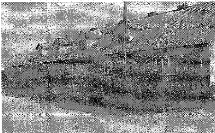
Fot. 14. Płyty azbestowo-cementowe na budynku w Bagrowie – II stopień pilności.
