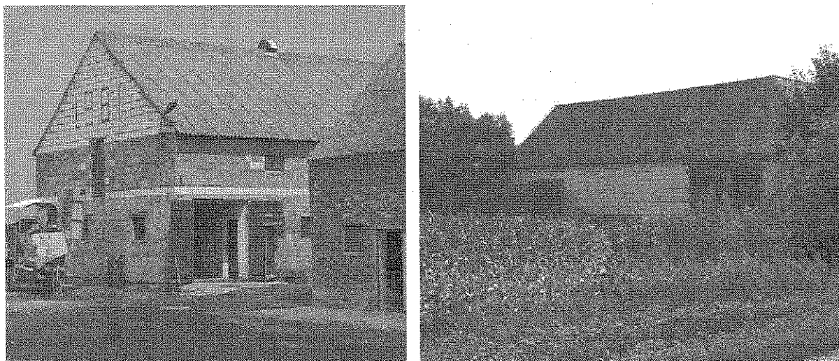
Fot. 5 i 6. Płyty azbestowo-cementowe faliste na budynkach gospodarskich w miejscowościach Poświętne i Bagrowo.
