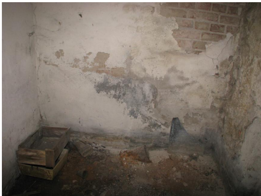
Fot. 18 – Ściany w piwnicy – widoczna korozja i ubytki tynków oraz ślady wilgoci. Stan techniczny materiału ceramicznego ściany w odsłoniętym fragmencie należy określić jako dobry.
