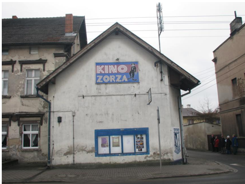
Fot. 15 – Ściana szczytowa (północna) budynku – widoczne zawilgocenia spowodowane najprawdopodobniej rozbryzgami wód opadowych.
