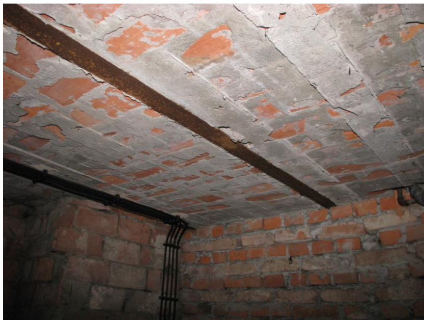
Fot. 21 – Zadowalający stan techniczny stropu Kleina nad piwnicą. Widoczna powierzchniowa korozja belek stalowych.
