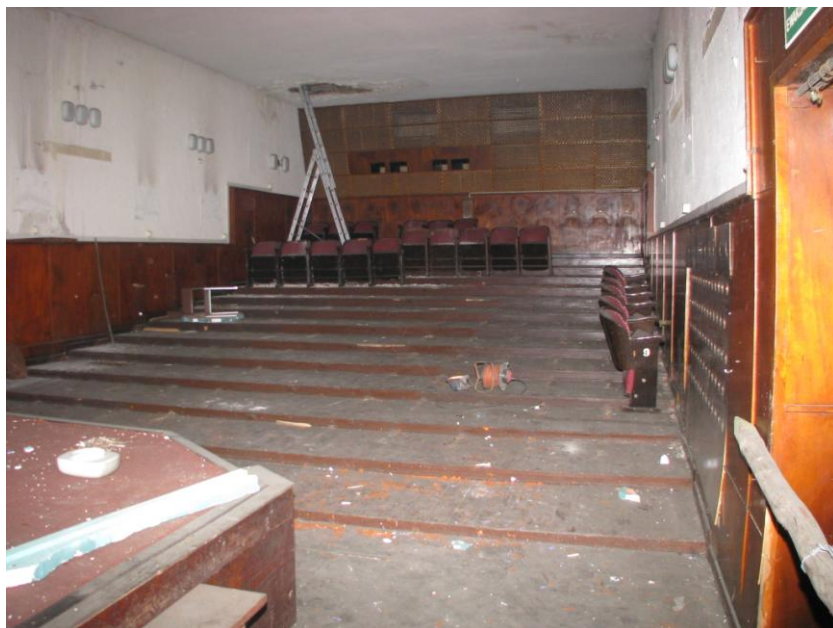
Fot. 24 – Widok ogólny sali kinowej – widoczna dewastacja nieużytkowanego pomieszczenia.
