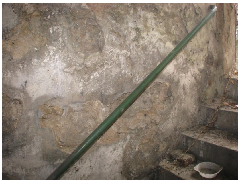
Fot. 17 – Silna korozja tynków ściennych kondygnacji podziemnej – ściana przy schodach zejściowych do piwnicy.
