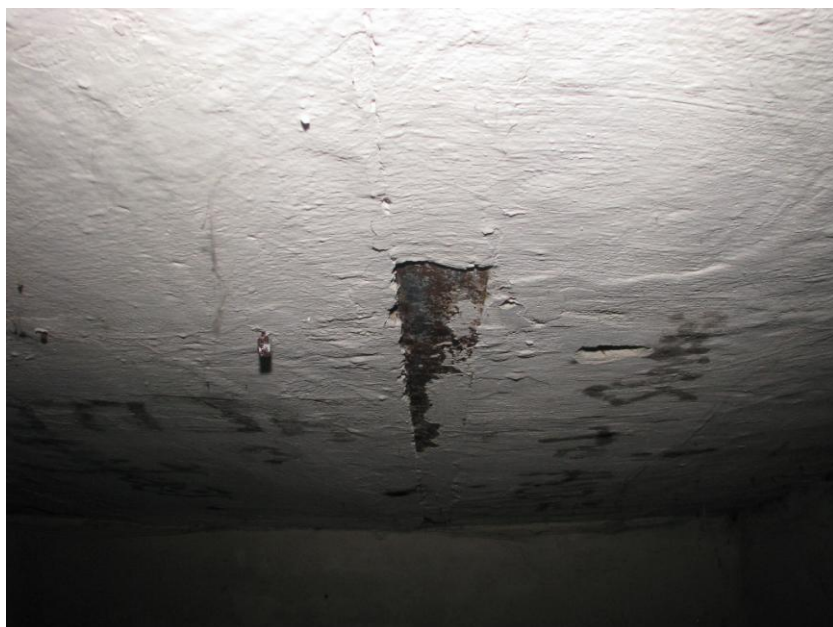
Fot. 22 – Kolejny przykład zadowalającego stanu technicznego stropu typu Kleina nad piwnicą. Widoczne odspojenia tynku na belkach stalowych oraz ich powierzchniowa korozja.
