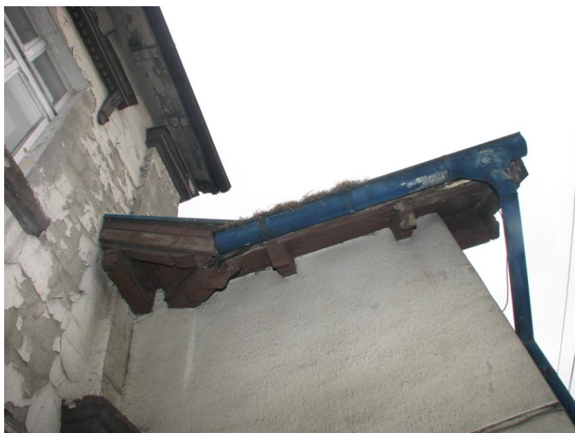
Fot. 10 – Przykład zalegających substancji organicznych w rynnie uniemożliwiających prawidłowe odprowadzanie wód opadowych do rury spustowej.
