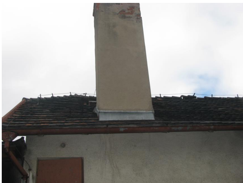
Fot. 7 – Połączenie wschodnia dachu (od strony podwórza), uwagę zwracają uszkodzenia gąsiorów w kalenicy (porównaj z fot. 5). Na pierwszym planie trzon kominowy znajdujący się w zadowalającym stanie technicznym – lokalnie zarejestrowano ubytki tynku.
