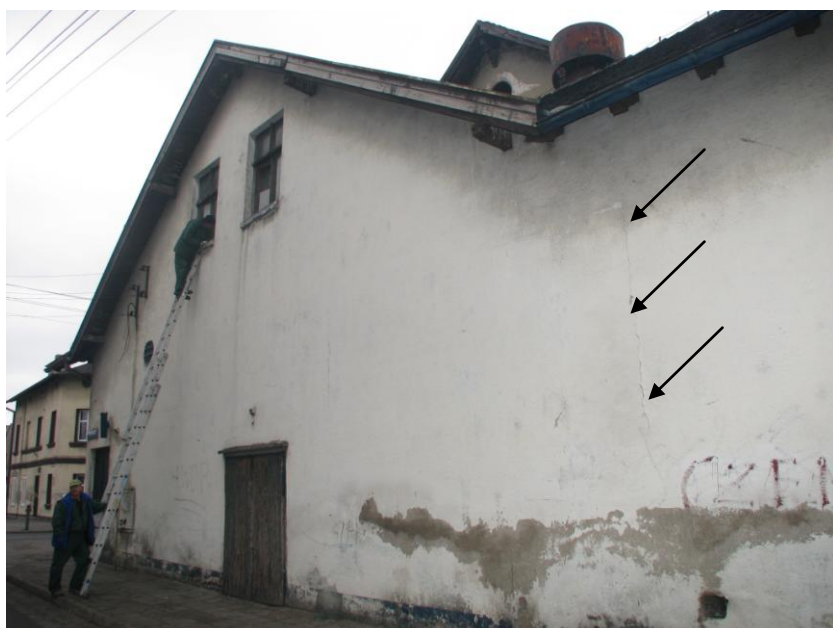
Fot. 11 – Ściana zachodnia budynku wzdłuż ul. Strumykowej – widoczne zarysowanie pionowe ściany oraz ślady zmurseń i zawilgoceń tynku.
