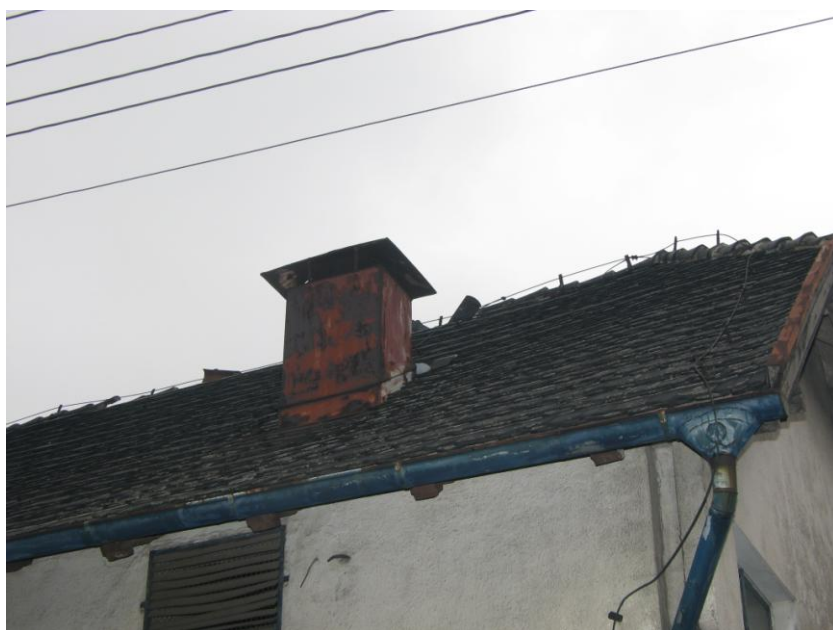
Fot. 5 – Zły stan techniczny pokrycia dachowego – widoczne uszkodzenia gąsiorów w kalenicy (połac zachodnia). Widoczne skorodowane stalowe przewody wentylacyjne.
