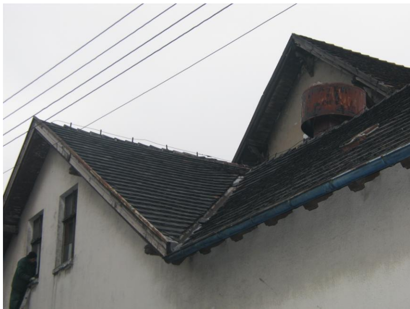
Fot. 6 – Kolejny przykład stanu pokrycia dachowego połaci zachodniej. W głębi widoczny skorodowany stalowy komin wentylacyjny.
