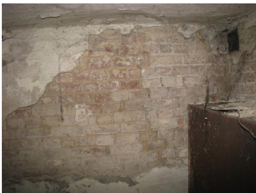
Fot. 20 – Kolejny przykład odspojenia tynku ściennego oraz dobrego stanu technicznego ceramicznego materiału ściennego.
