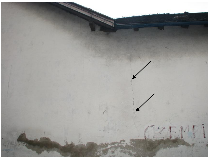
Fot. 12 – Zarysowanie pionowe ściany widocznej na fot. 11.
