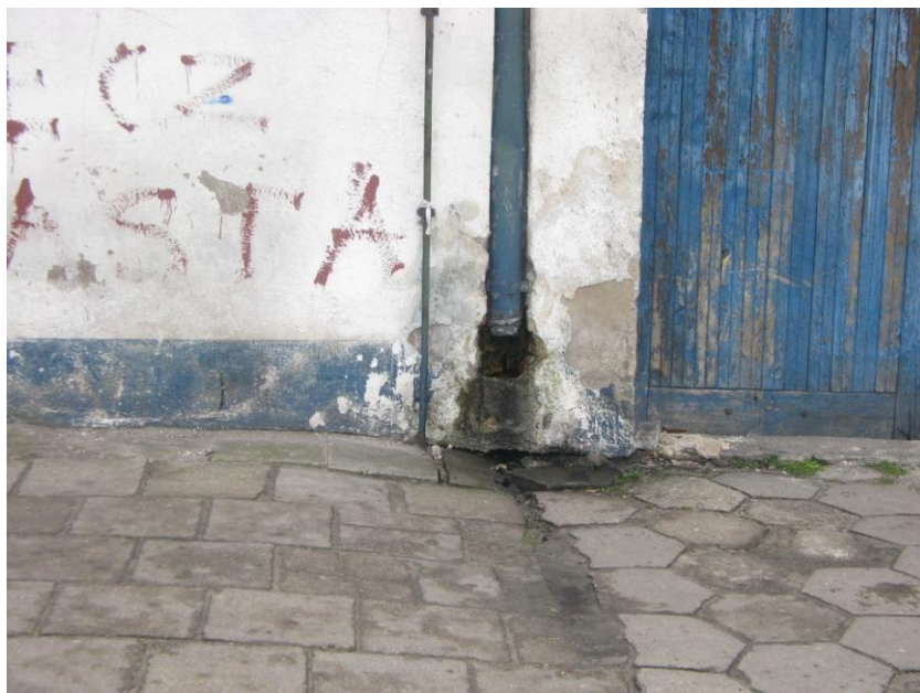
Fot. 9 – Przykład niekontrolowanego zrzutu wody opadowej rurą spustową bezpośrednio w ścianę budynku.
