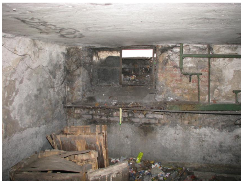
Fot. 19 – Kolejny przykład zniszczeń i zawilgoceń ścian piwnicy. Zawilgocenia są skutkiem przede wszystkim infiltracji poprzez zniszczone okna wody opadowej z poziomu terenu.
