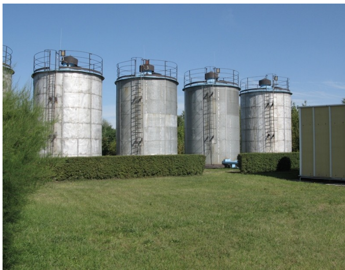
Zdjęcie 5. Zbiorniki wyrównawcze na SUW Czempień
