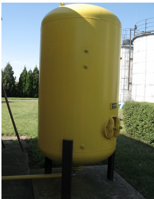
Zdjęcie 1. Zbiornik akumulacyjny powietrza na SUW Czempin
