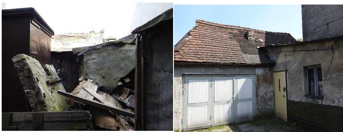
Zdjęcie 21. Zdewastowane budynki
