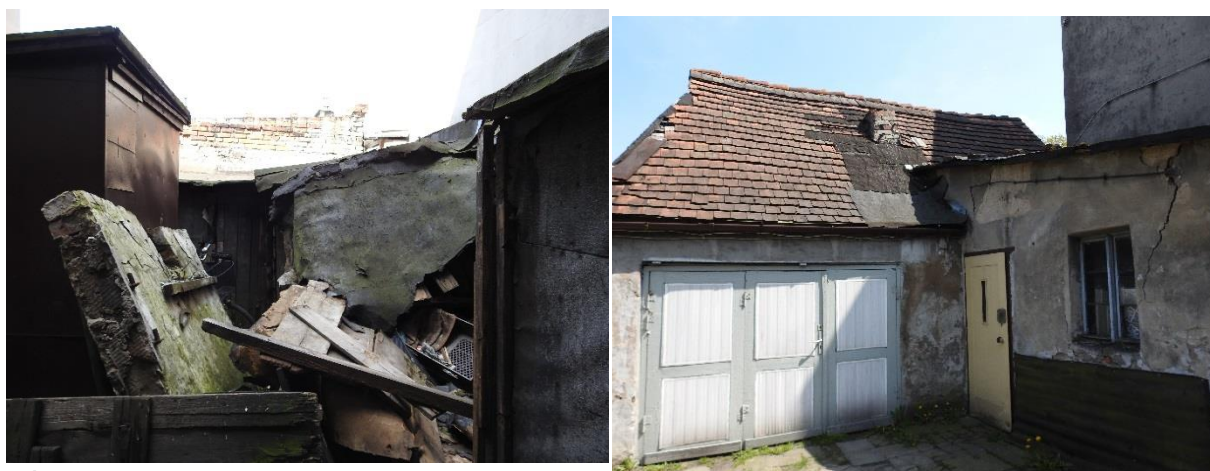
Zdjęcie 21. Zdewastowane budynki
