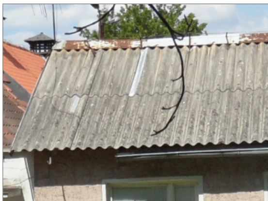
Fot.1 Płyty azbestowo-cementowe faliste
